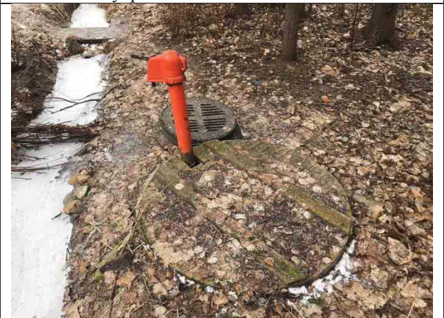
Фото 20. Колодец на участке (местное водоснабжение)
