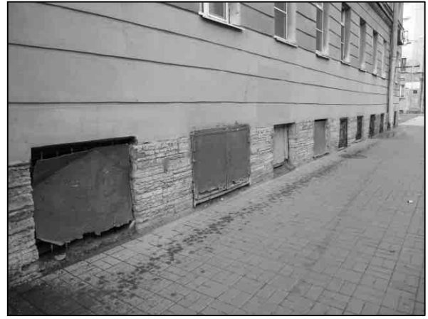
Фото 14. Типичное состояние оконных проемов, с ориентацией – на улицу
