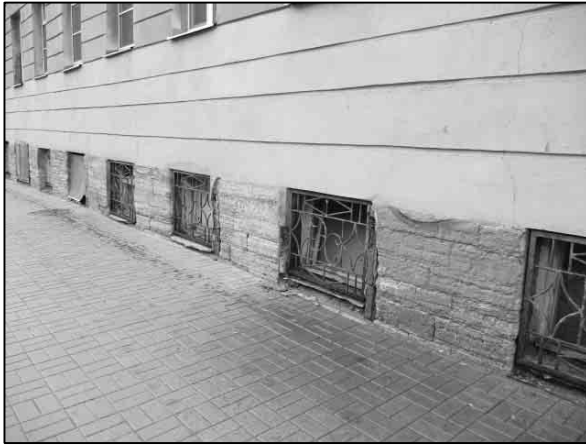
Фото 13. Типичное состояние оконных проемов, с ориентацией – на улицу
