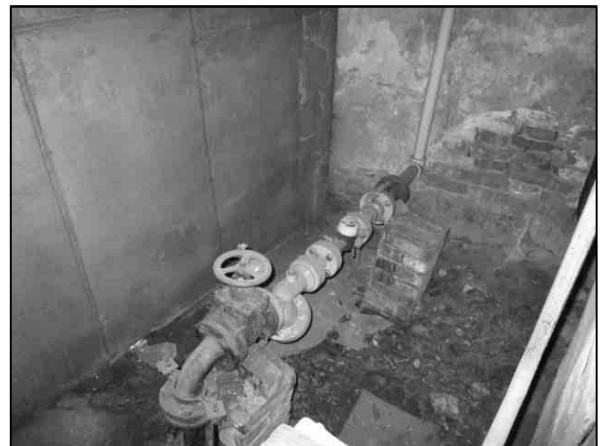
Фото 12. Водомерный узел в помещении
