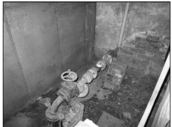
Фото 12. Водомерный узел в помещении
