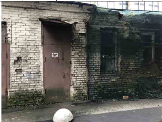
Фото 10. Состояние здания Объекта оценки (вываливание кирпичей из кладки)
