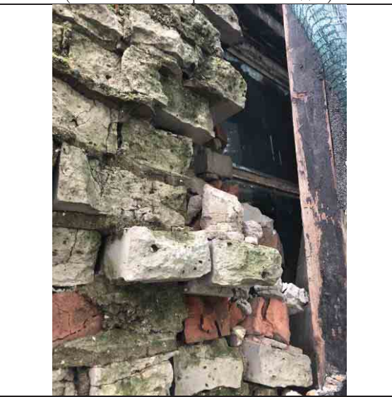
Фото 12. Состояние здания Объекта оценки (вываливание кирпичей из кладки)
