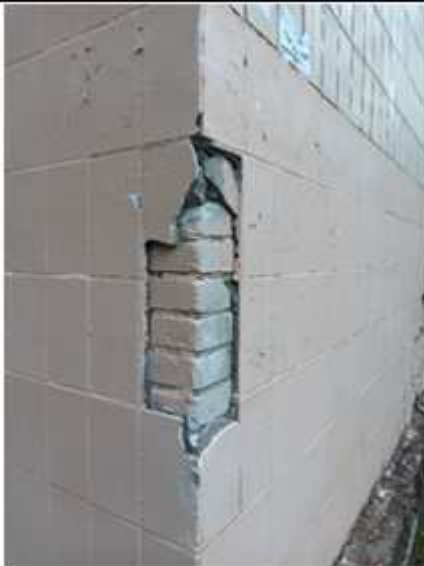
Фото №7: Повреждения отделки фасада
