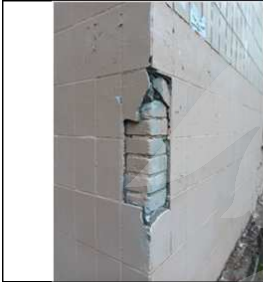
Фото №7: Повреждения отделки фасада
