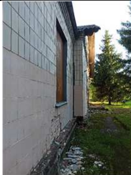
Фото №8: Повреждения отделки фасада
