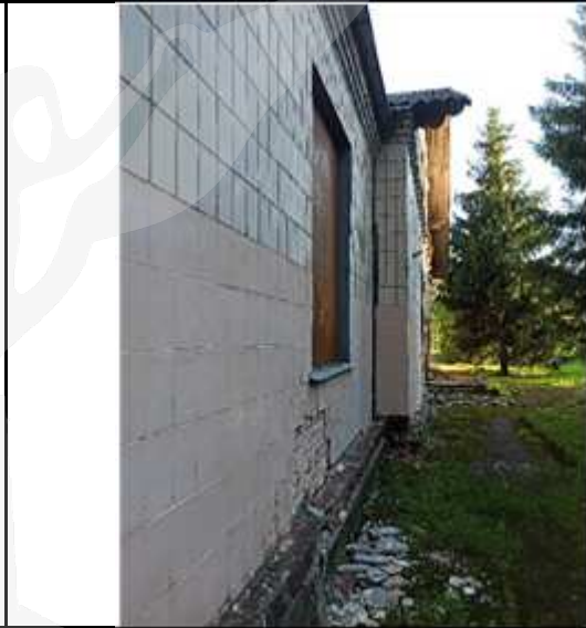
Фото №8: Повреждения отделки фасада
