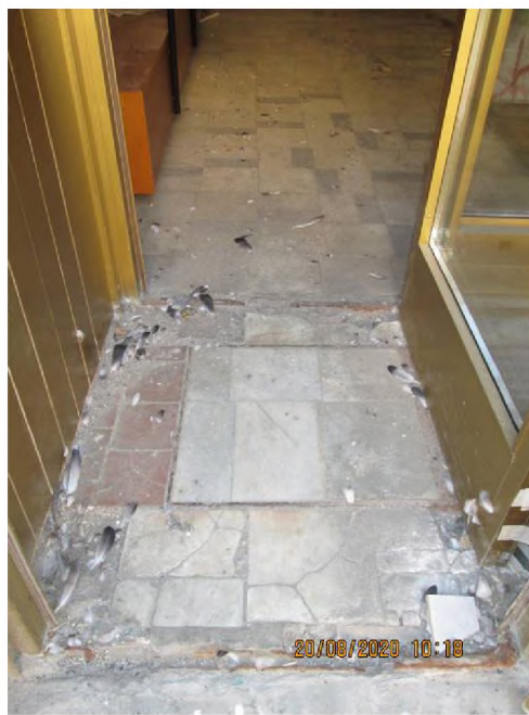
Фото 12. Состояние пола в ч.п. 1.
