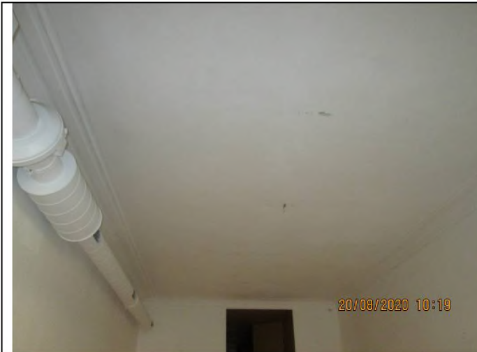
Фото 15. Состояние потолка в ч.п. 2.
