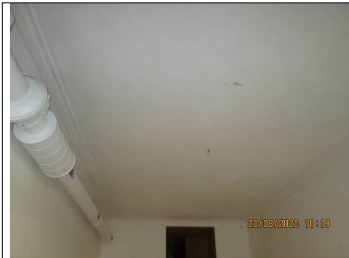
Фото 15. Состояние потолка в ч.п. 2.
