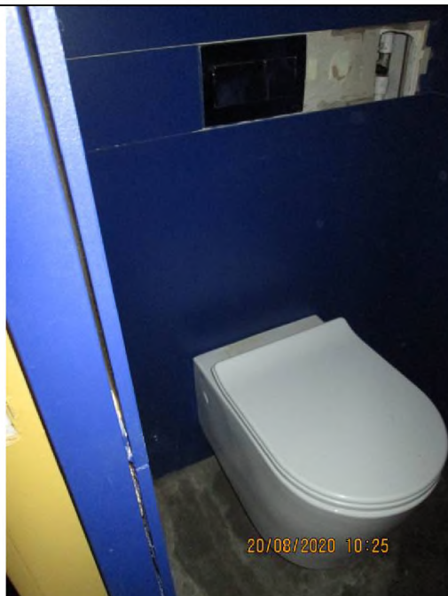
Фото 23. Текущее состояние санузла (ч.п. 4)
