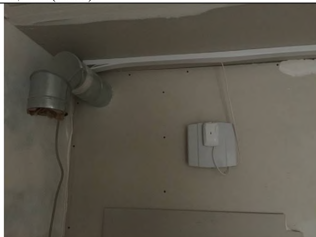
Фото 28. Состояние внутренней отделки объекта оценки (ч.п. 5).
