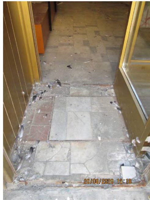
Фото 12. Состояние пола в ч.п. 1.
