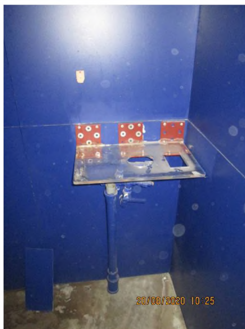
Фото 24. Текущее состояние санузла (ч.п. 4)
