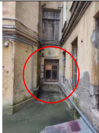
Фото 24 Фасад здания, окно помещения
