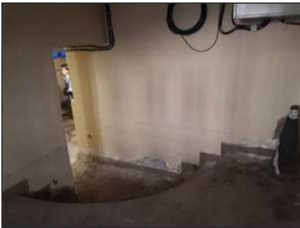
Фото 33. Состояние помещения подвала
