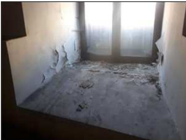
Фото 29. Состояние помещения подвала
