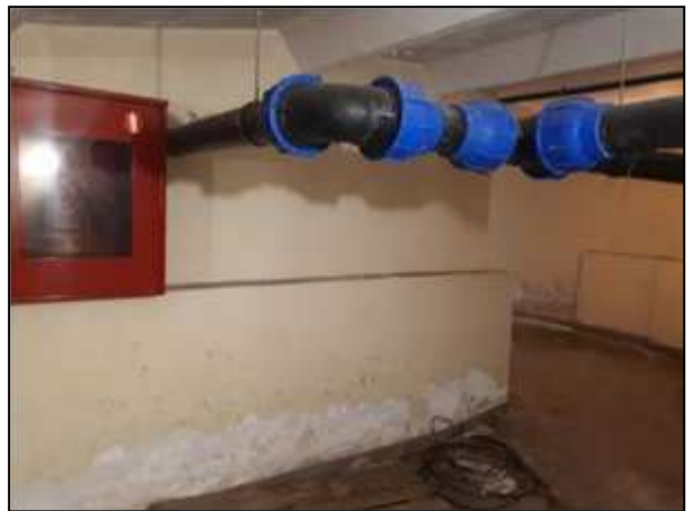
Фото 34. Состояние помещения подвала
