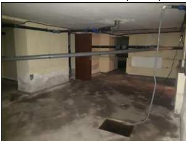
Фото 27. Состояние помещения подвала
