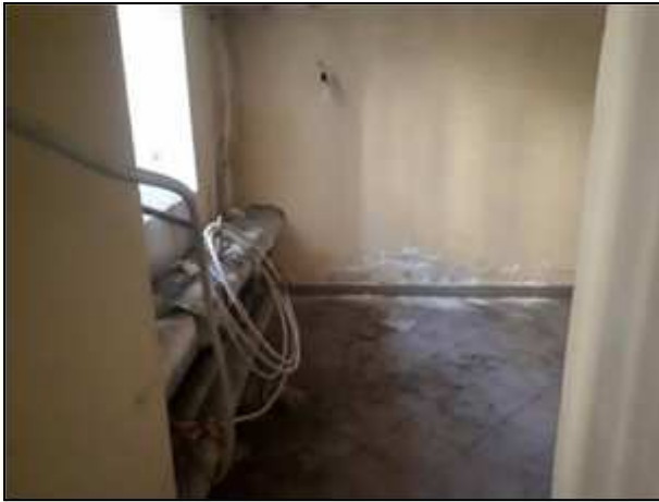
Фото 31. Состояние помещения подвала
