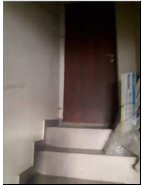
Фото 32. Состояние помещения подвала
