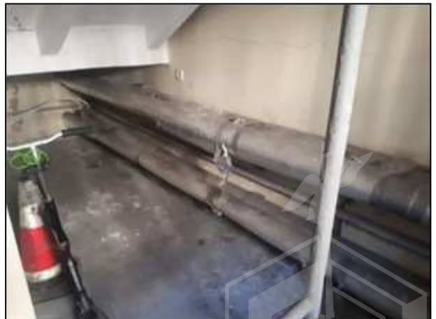
Фото 30. Состояние помещения подвала
