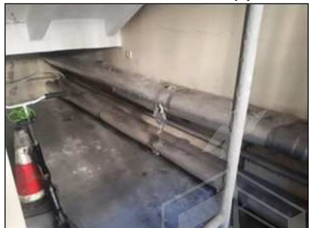
Фото 30. Состояние помещения подвала
