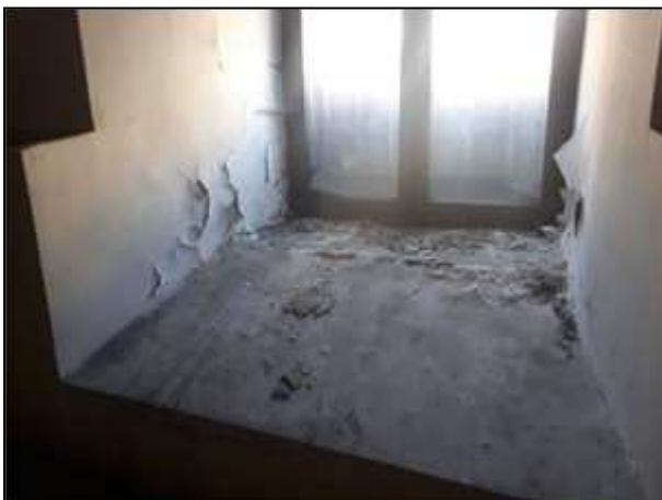
Фото 29. Состояние помещения подвала
