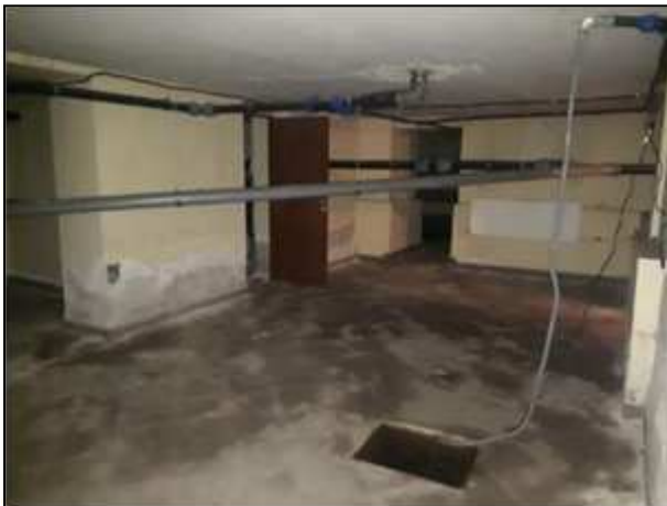
Фото 27. Состояние помещения подвала
