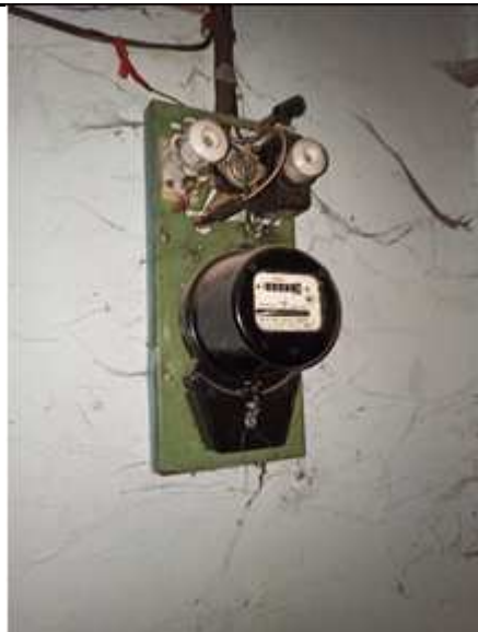
Фото №14 Электросчетчик в помещении
