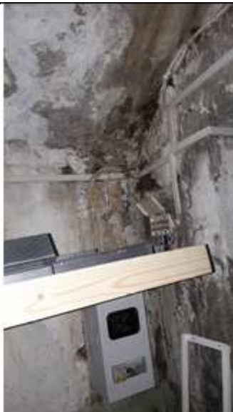
Фото №31 Элементы инженерной инфраструктуры
