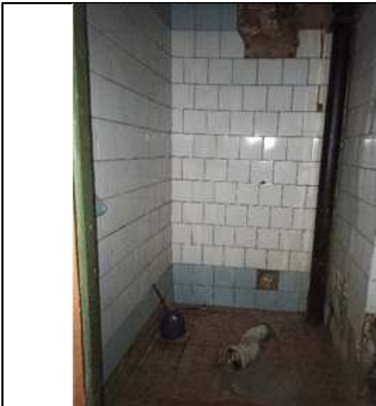
Фото №31 Сан. узел на 1 этаже
