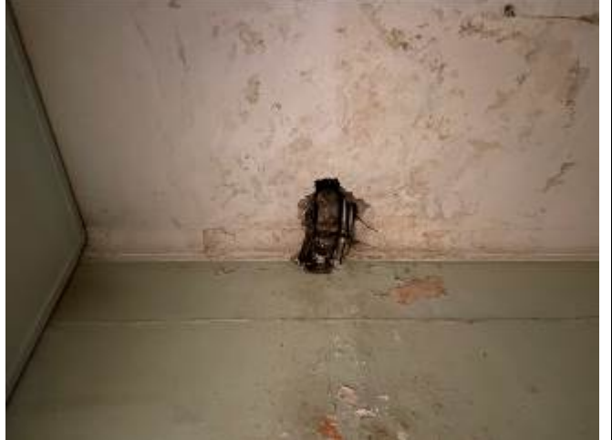
Фото №16. Внутренний вид, повреждения
