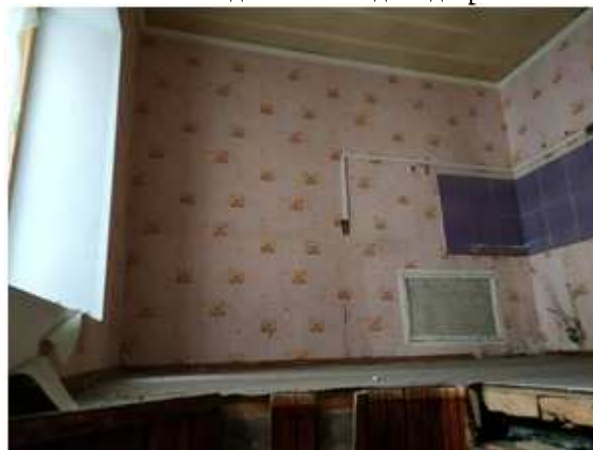
Фото 10. Ч.п. 3 пом. 2-Н (2-й этаж) в которую ранее был организован доступ с 1-го этажа. На дату оценки лестница с первого на второй этаж демонтирована.
