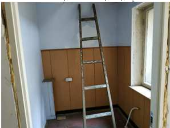
Фото 9. Ч.п. 3 пом. 1-Н из которого ранее осуществлялся доступ в пом. 2-Н, расположенное на 2-м этаже. На дату оценки лестница демонтирована
