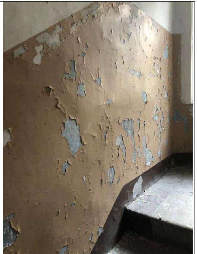
Фото 34. Состояние лестничной клетки со стороны входа №2
