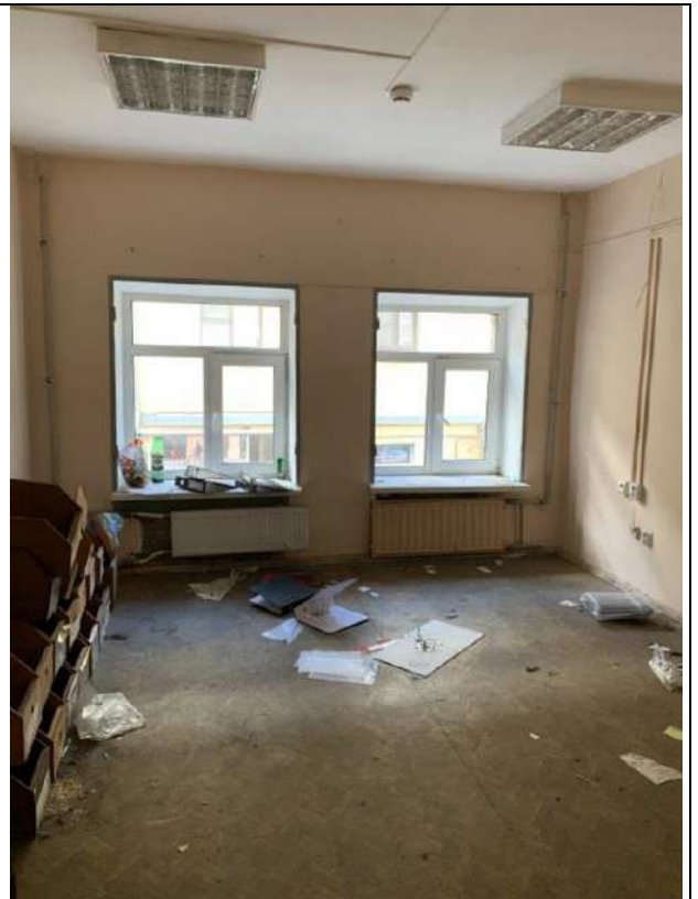
Фото 50. Состояние внутренней отделки пом. 3-Н (второй этаж)
