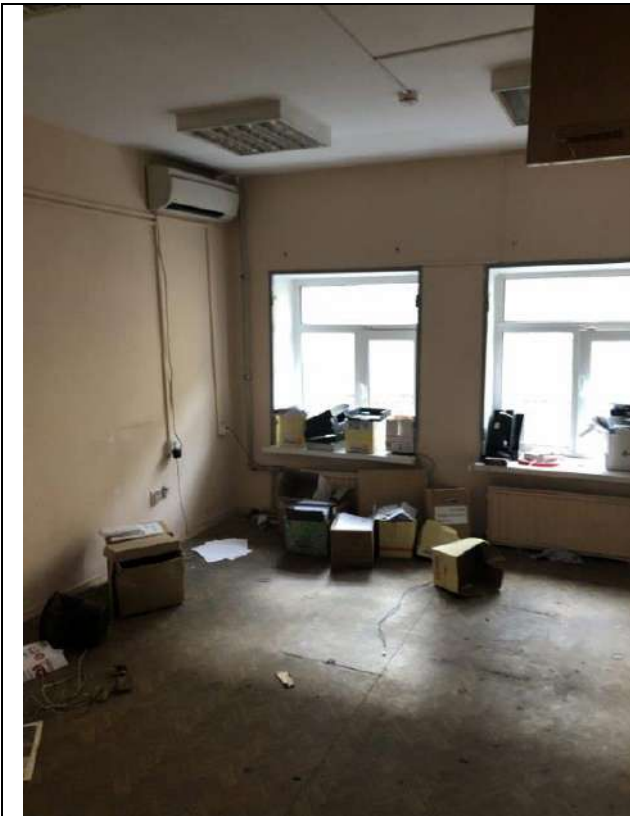
Фото 53. Состояние внутренней отделки пом. 3-Н (второй этаж)
