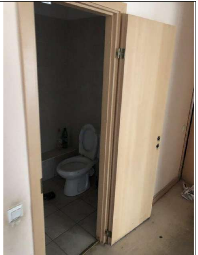
Фото 42. Состояние внутренней отделки пом. 3-Н (второй этаж)
