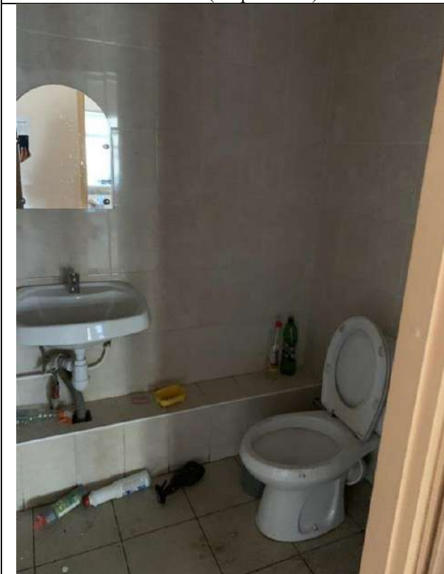
Фото 43. Состояние внутренней отделки пом. 3-Н (второй этаж)
