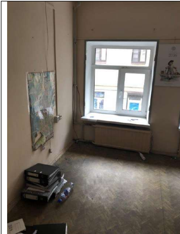
Фото 41. Состояние внутренней отделки пом. 3-Н (второй этаж)
