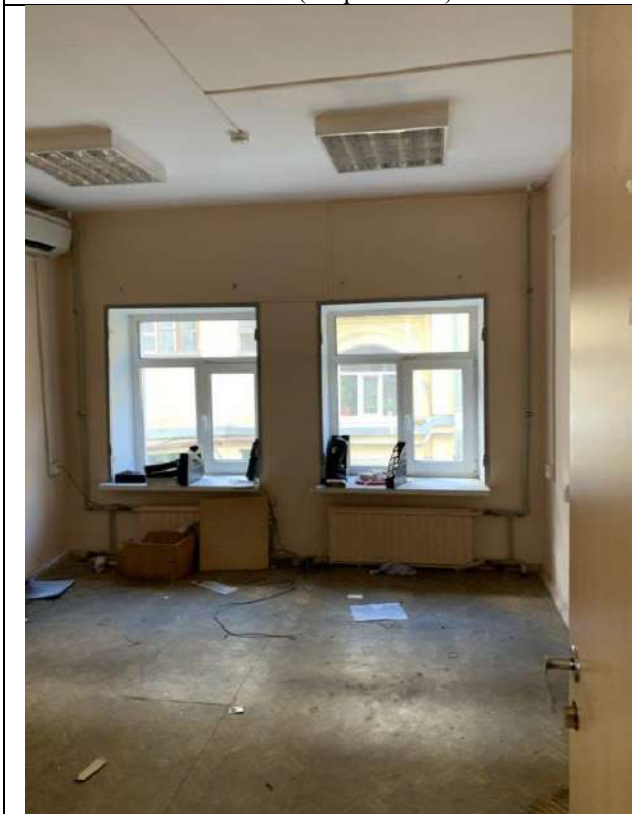
Фото 51. Состояние внутренней отделки пом. 3-Н (второй этаж)
