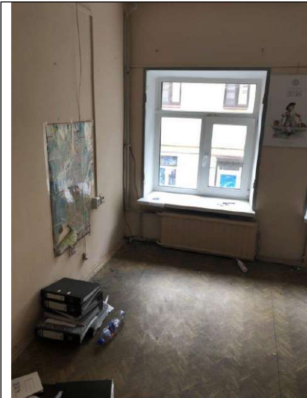
Фото 41. Состояние внутренней отделки пом. 3-Н (второй этаж)
