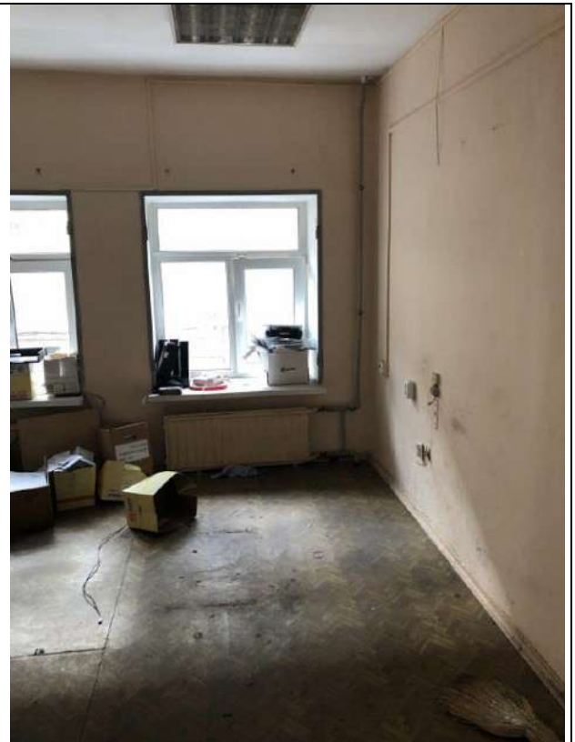
Фото 54. Состояние внутренней отделки пом. 3-Н (второй этаж)
