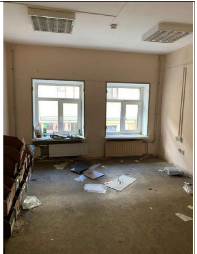
Фото 50. Состояние внутренней отделки пом. 3-Н (второй этаж)
