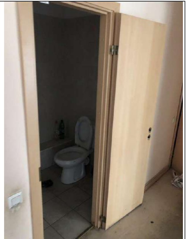
Фото 42. Состояние внутренней отделки пом. 3-Н (второй этаж)
