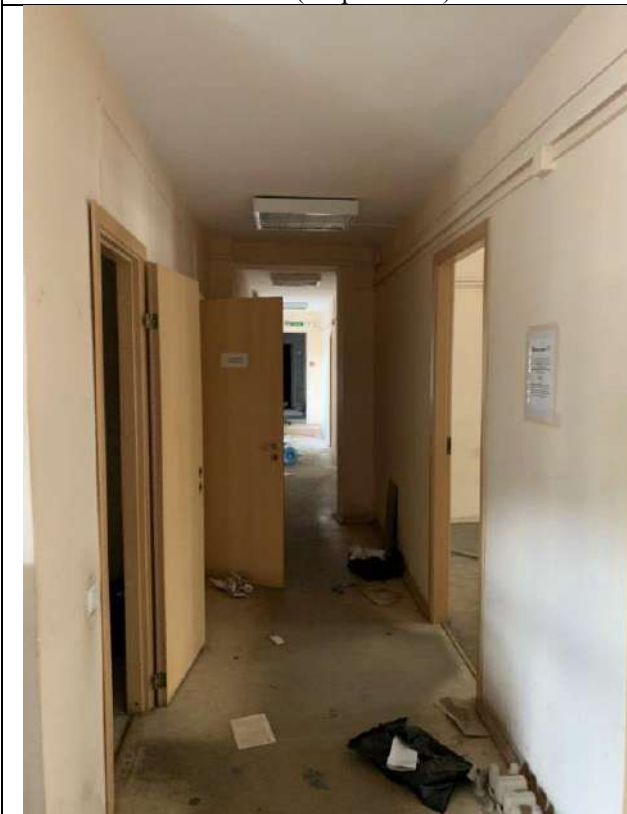
Фото 39. Состояние внутренней отделки пом. 3-Н (второй этаж)
