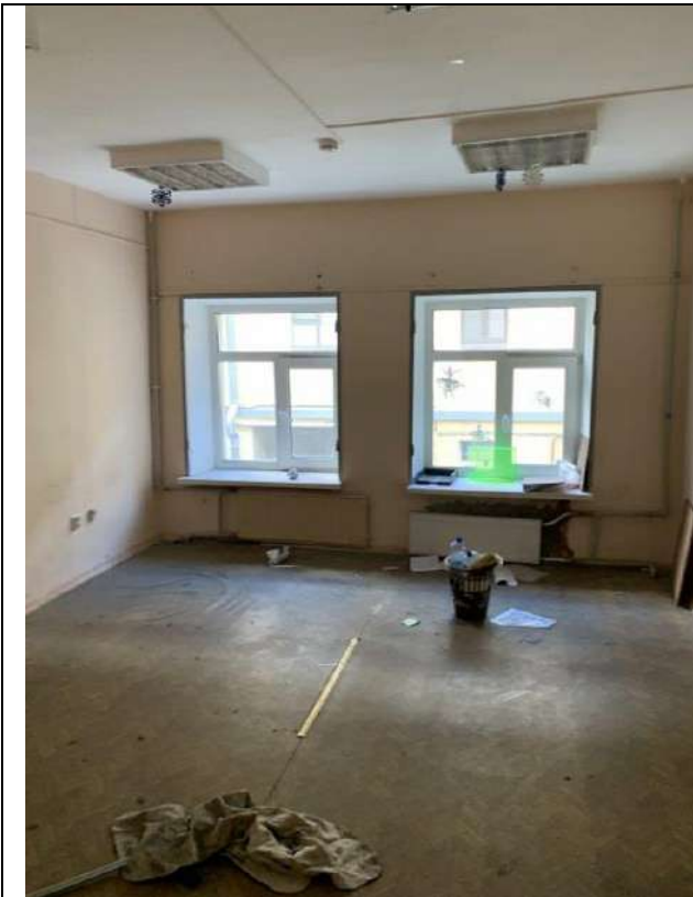
Фото 45. Состояние внутренней отделки пом. 3-Н (второй этаж)
