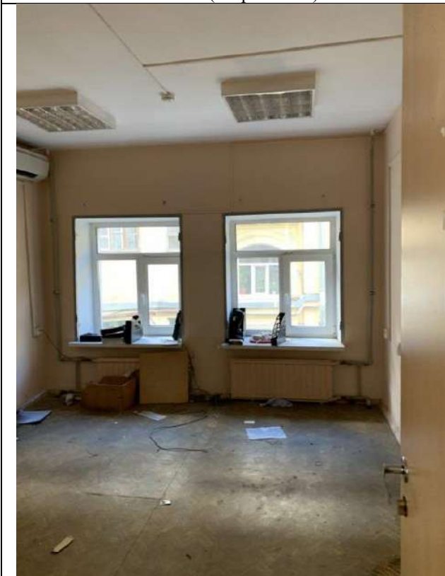
Фото 51. Состояние внутренней отделки пом. 3-Н (второй этаж)
