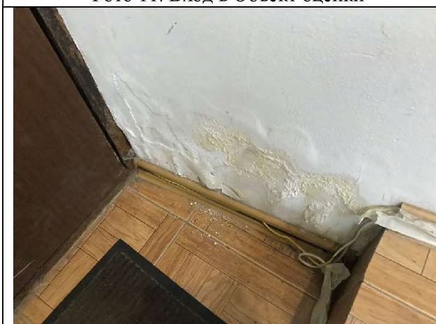
Фото 13. Состояние ч.п. 1 пом. 16-Н
