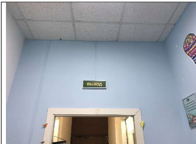
Фото 17. Состояние ч.п. 2 пом. 16-Н
