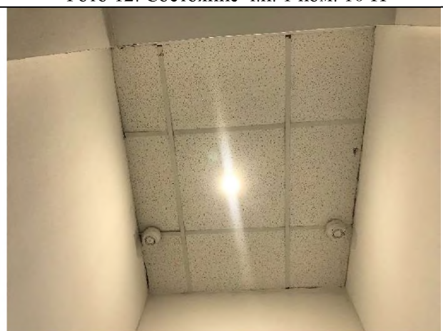
Фото 14. Состояние ч.п. 1 пом. 16-Н
