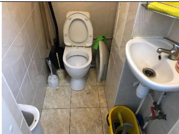
Фото 27. Состояние ч.п. 5 пом. 16-Н
