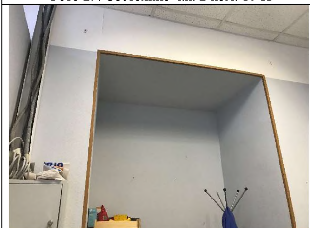
Фото 31. Состояние ч.п. 2 пом. 16-Н
