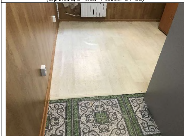
Фото 21. Состояние ч.п. 4 пом. 16-Н
