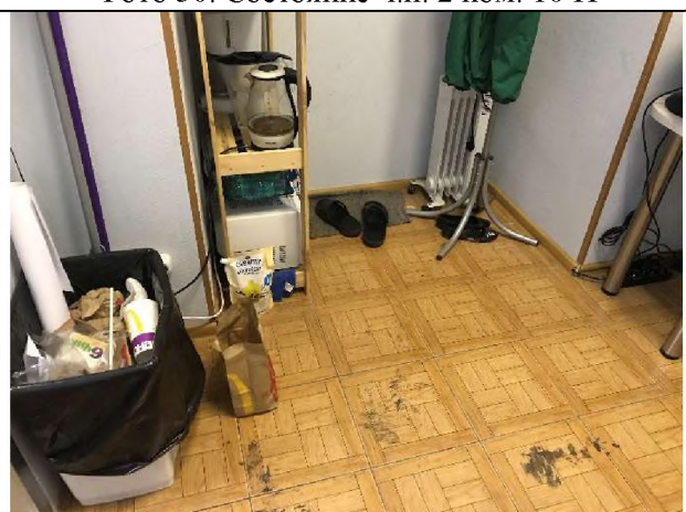
Фото 32. Состояние ч.п. 2 пом. 16-Н
