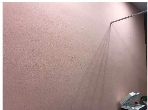
Фото 38. Состояние ч.п. 3 пом. 16-Н
