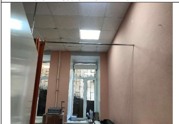
Фото 33. Состояние ч.п. 3 пом. 16-Н
