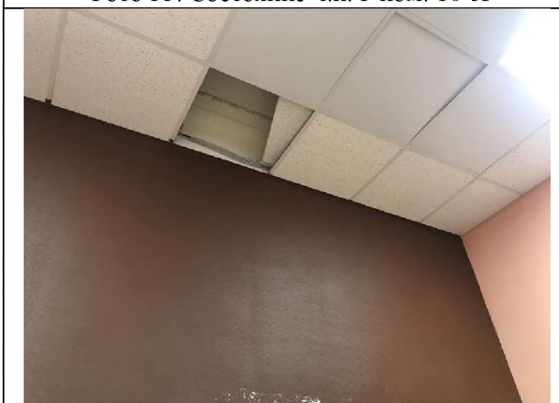
Фото 35. Состояние ч.п. 3 пом. 16-Н
