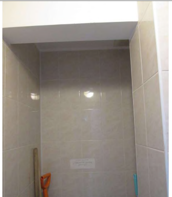
Фото 26. Состояние ч.п. 5 пом. 16-Н
