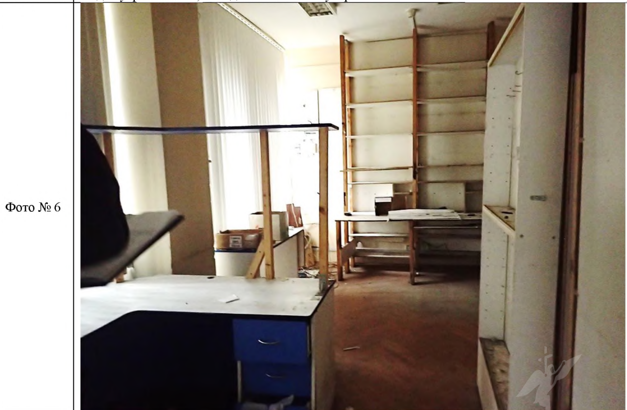
Описание: Вид внутри Объекта, находится бытовой мусор
