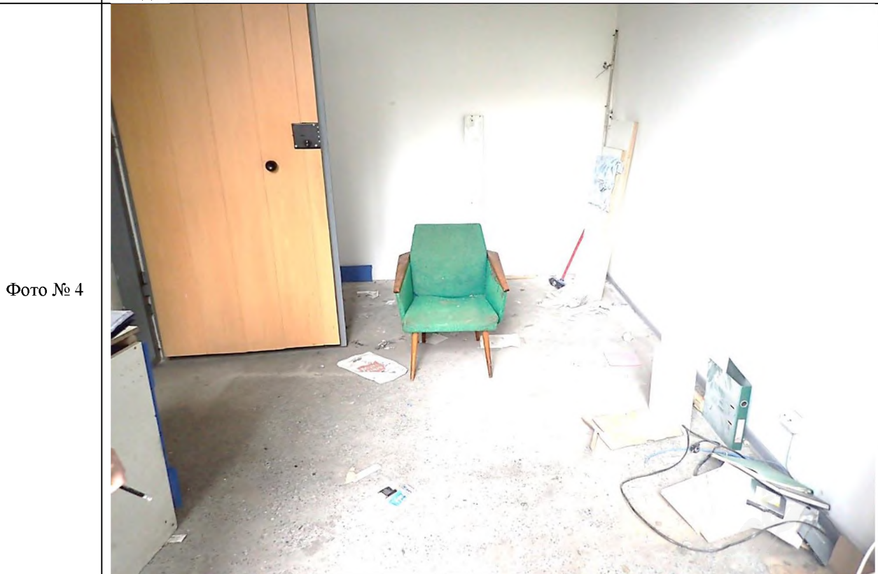
Описание: Вид внутри Объекта, находится бытовой мусор
