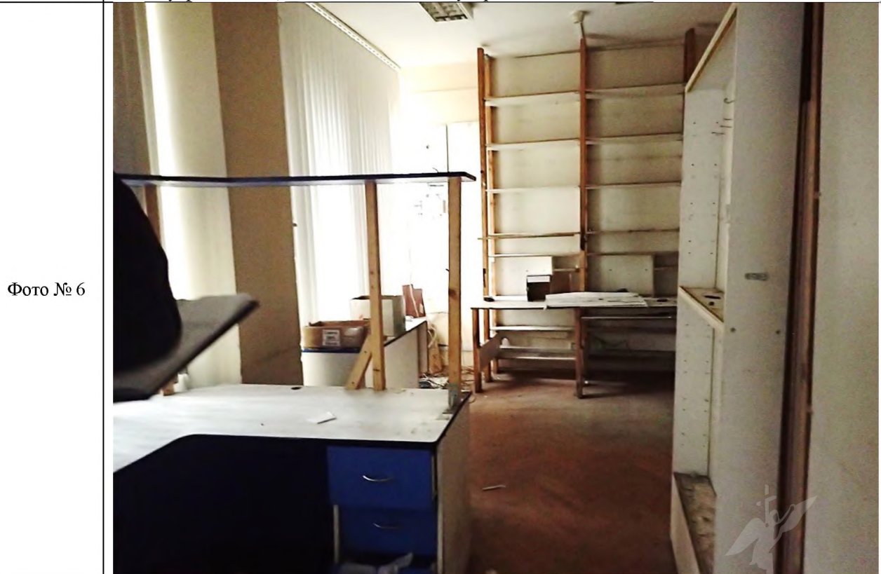
Описание: Вид внутри Объекта, находится бытовой мусор
