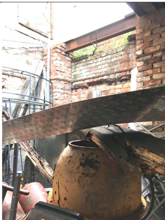
Фото 1. Проход в ч. п. №2 и №3 (разрушены стены, кровля, коммуникации утрачены)
