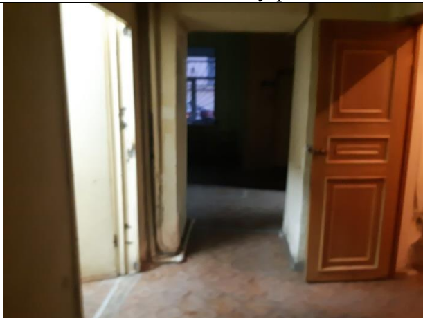
Фото 39. Состояние внутренней отделки.
