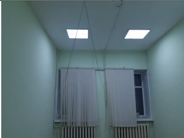
Фото 47. Состояние внутренней отделки.
