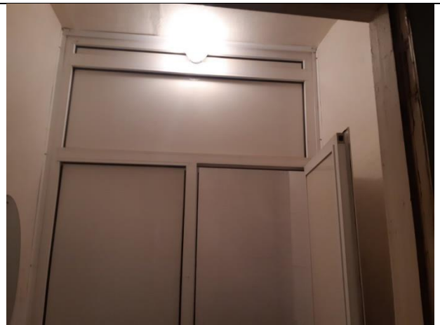
Фото 28. Состояние внутренней отделки.
