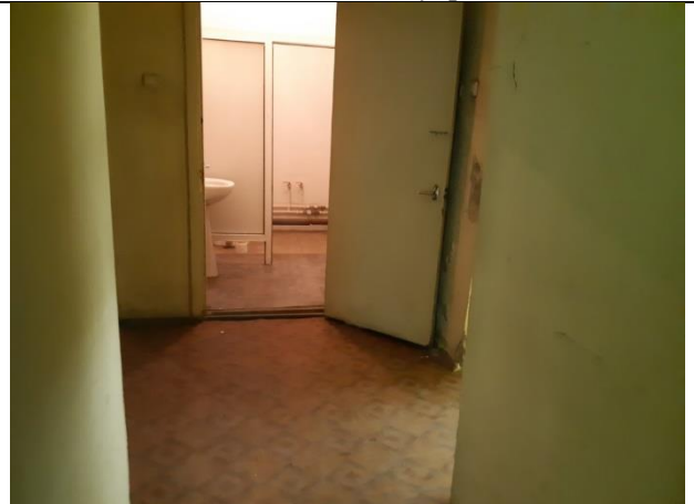
Фото 24. Состояние внутренней отделки.
