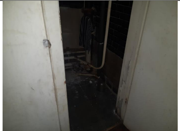
Фото 32. Состояние внутренней отделки.
