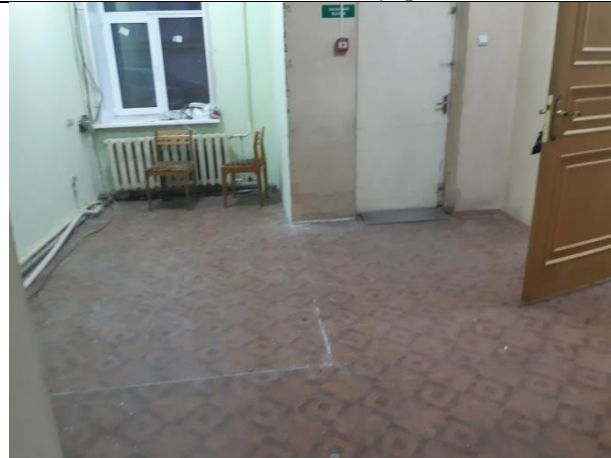
Фото 48. Состояние внутренней отделки.
