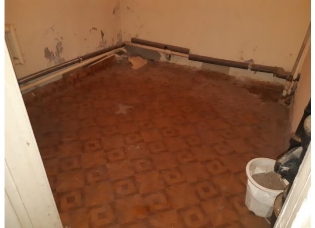
Фото 30. Состояние внутренней отделки.
