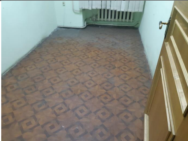
Фото 37. Состояние внутренней отделки.
