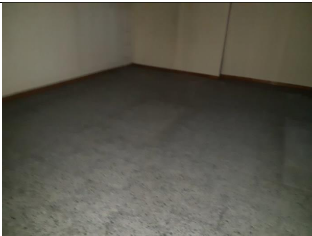
Фото 19. Состояние внутренней отделки.
