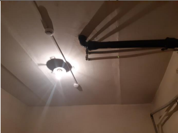
Фото 31. Состояние внутренней отделки.
