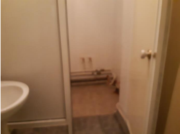
Фото 29. Состояние внутренней отделки.
