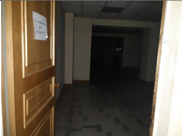
Фото 23. Состояние внутренней отделки.
