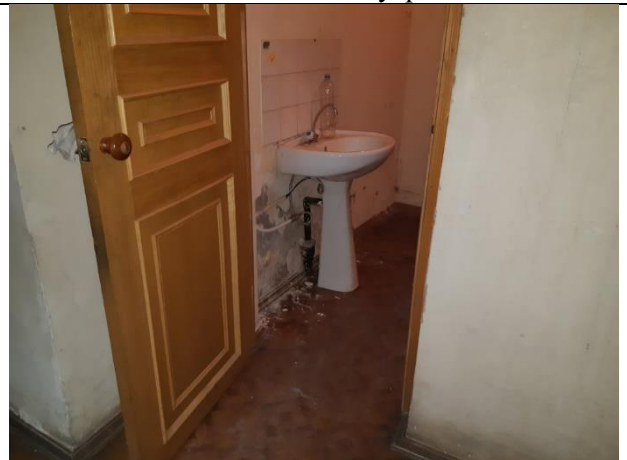
Фото 40. Состояние внутренней отделки.
