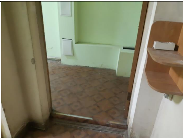
Фото 35. Состояние внутренней отделки.
