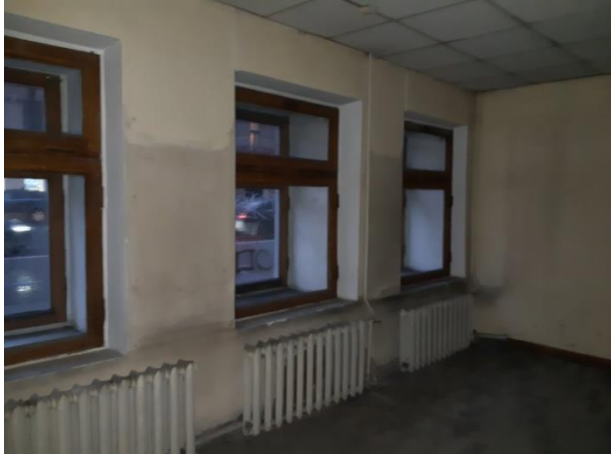
Фото 21. Состояние внутренней отделки.
