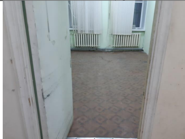
Фото 46. Состояние внутренней отделки.
