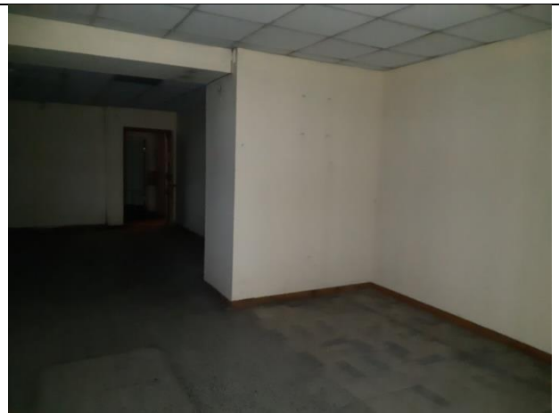
Фото 20. Состояние внутренней отделки.
