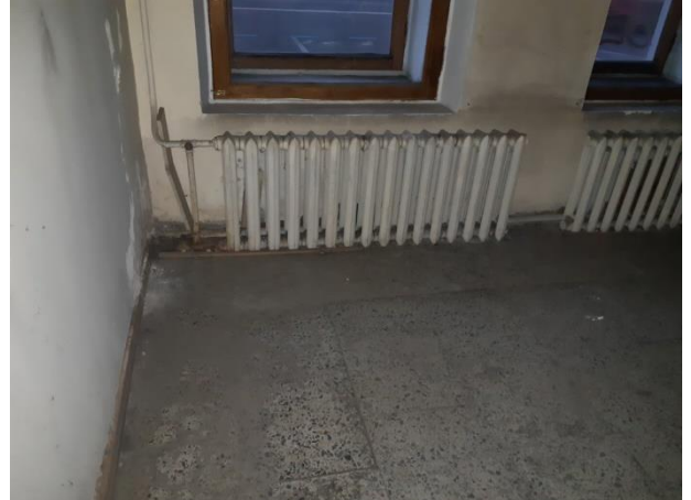
Фото 22. Состояние внутренней отделки.
