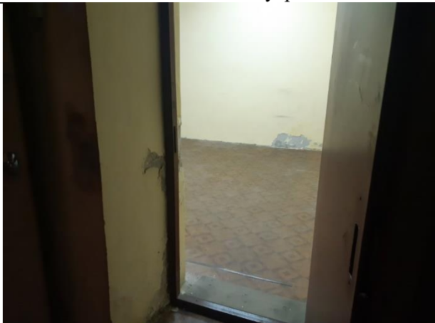
Фото 25. Состояние внутренней отделки.
