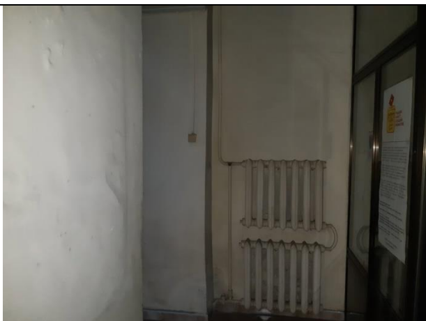
Фото 15. Состояние внутренней отделки.
