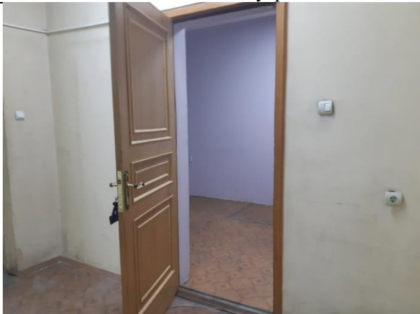
Фото 49. Состояние внутренней отделки.
