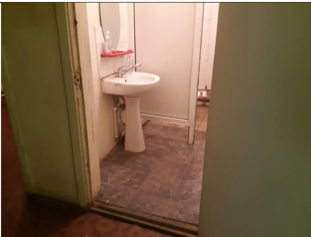
Фото 27. Состояние внутренней отделки.
