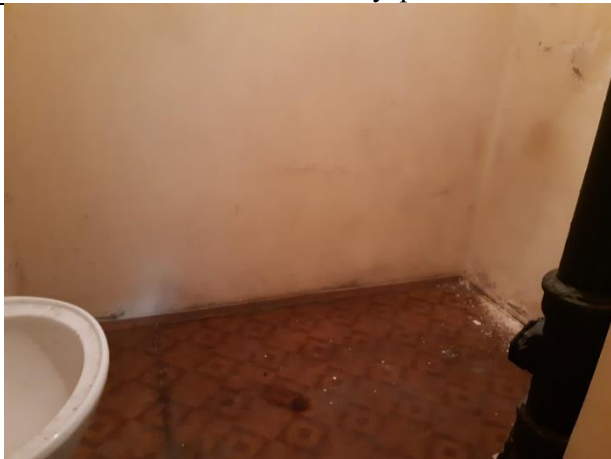
Фото 41. Состояние внутренней отделки.
