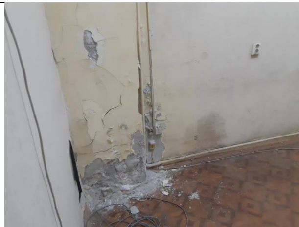
Фото 44. Состояние внутренней отделки.
