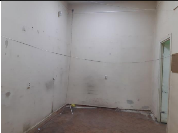
Фото 45. Состояние внутренней отделки.
