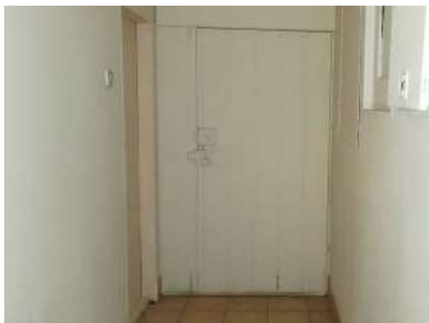
Фото 15. Общий вход с нежилыми помещениями со двора (дверной проем закрыт – вид изнутри)
