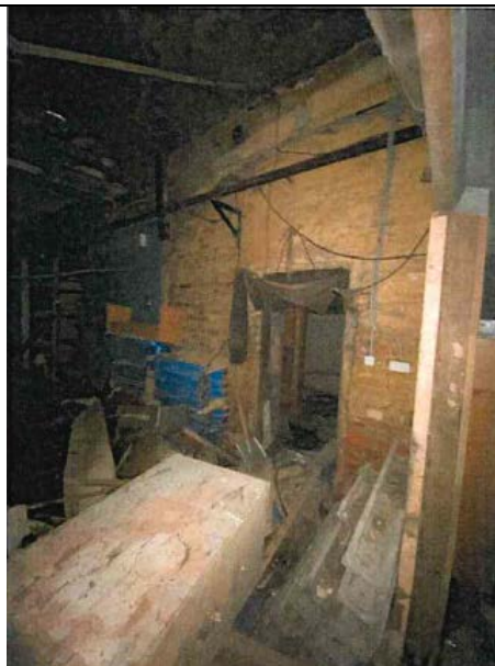
Фото 17. Отсутствует входная дверь в Объект оценки
