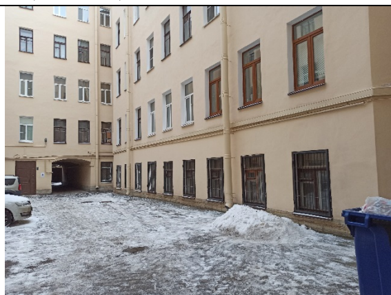
Фото №2: Окна пом. 1-Н и 4-Н
