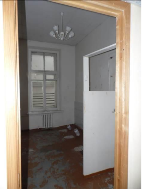
Фото 120 Состояние помещения (санузел)
