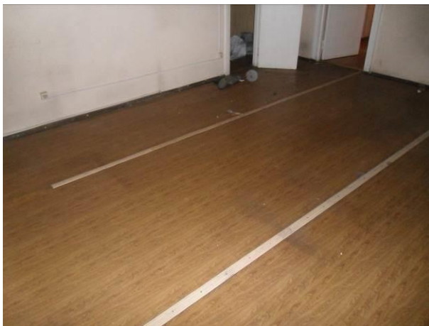
Фото 161 Состояние помещения (полы)
