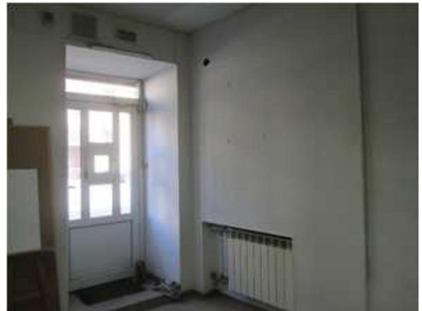
Фото 18. Ч.п. 1 (отсутствует оконный проем, по плану)
