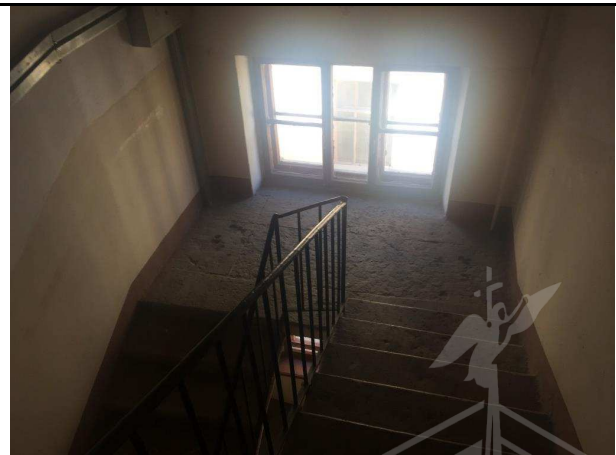
Фото 18. Типичное состояние лестничного проёма Объекта оценки
