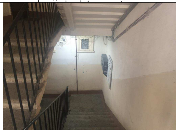
Фото 16. Типичное состояние лестничного проёма Объекта оценки
