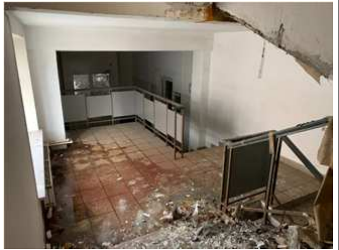
Фото №16 Лестница с заблокированным входом
