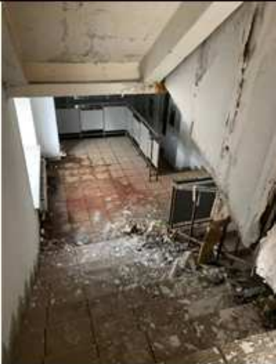
Фото №15 Лестница с заблокированным входом
