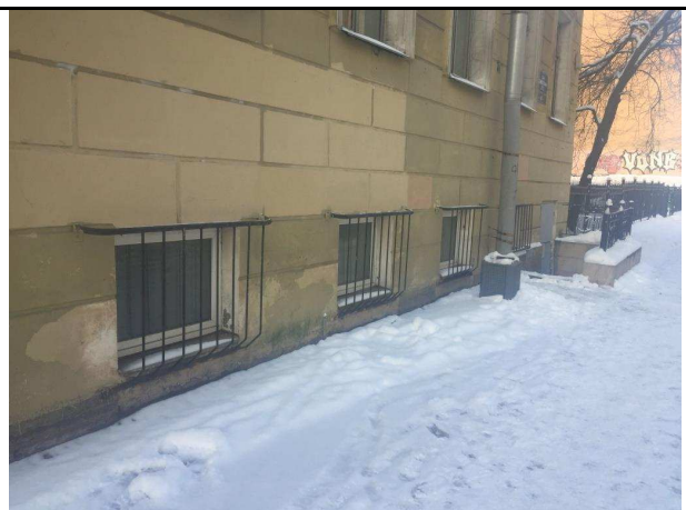
Фото 10. Оконная и входная группа Объекта оценки
