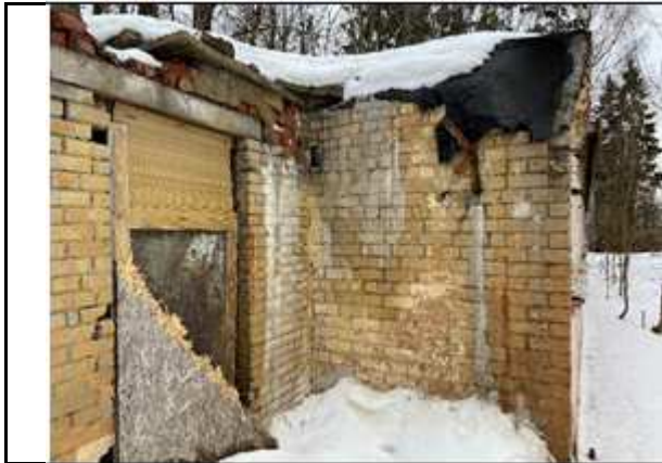
Фото №7: Внешний вид здания. Повреждения
