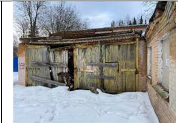
Фото №8: Внешний вид здания. Повреждения
