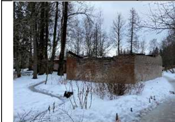
Фото №9: Внешний вид здания. Повреждения
