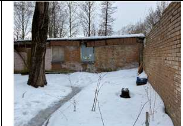
Фото №10: Внешний вид здания. Повреждения
