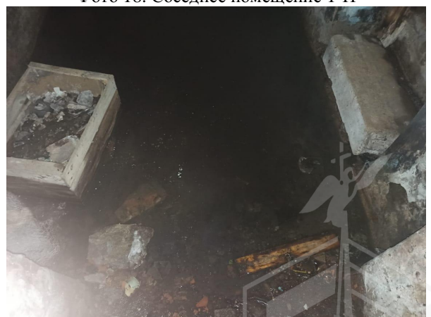
Фото 20. Затопление Объекта оценки
