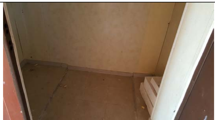
Фото 16. Состояние внутренней отделки Объекта оценки (состояние пола)
