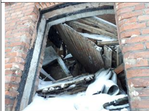
Фото 5. Состояние окон и межэтажных перекрытий Объекта оценки
