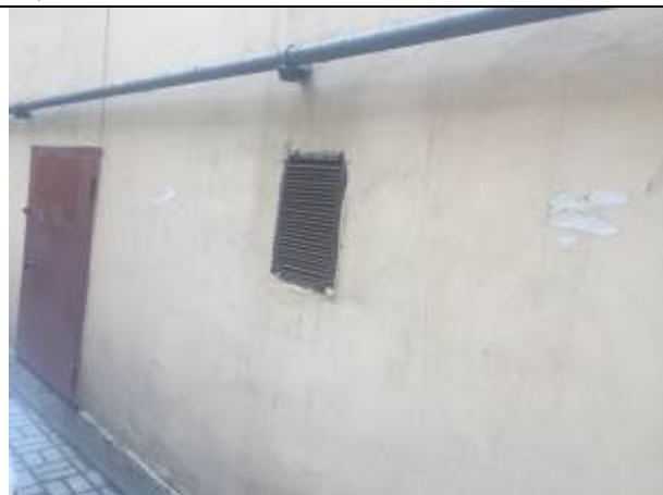
Фото 14. Оконные проемы в ч.п. 3 (1 заложен, второй переоборудован под погрузочное окно.
