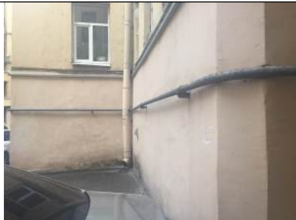
Фото 15. Заложённые оконные проемы в ч.п.4 и в ч.п.5
