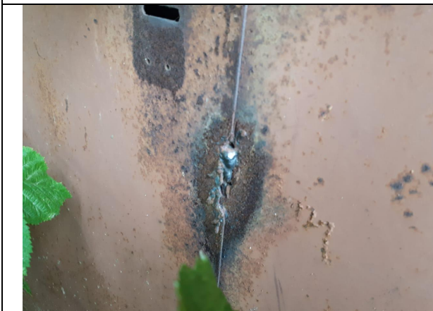
Фото 15. Доступ в здание закрыт – металлическая входная дверь заварена
