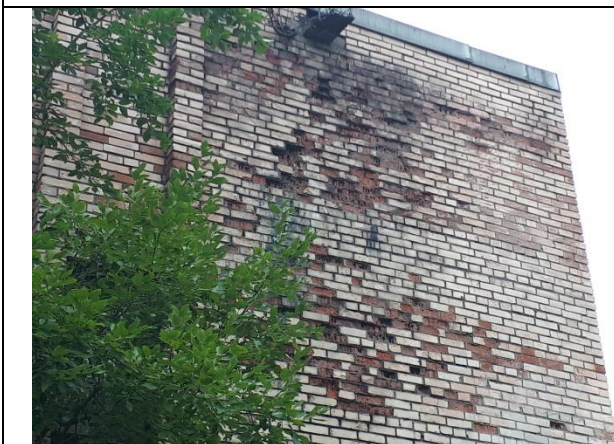
Фото 13. Состояния здания Объекта оценки
