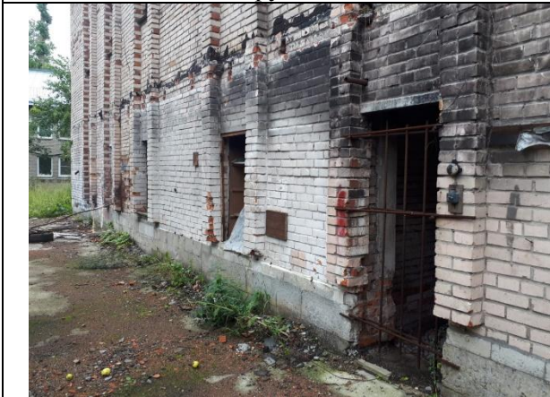
Фото 11. Состояния здания Объекта оценки
