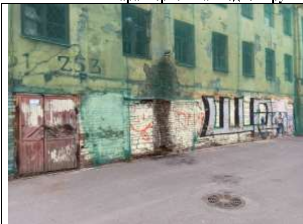
Фото 11. Общий вход со двора и окна (заложены кирпичом)
