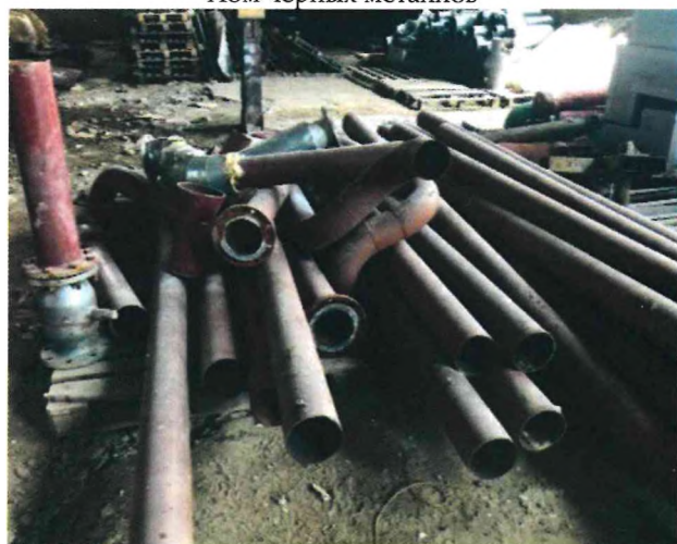
трубопровод разн.диаметров с запорной арматурой
