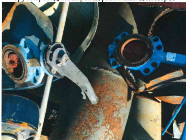
Запорная арматура и трубопровод
