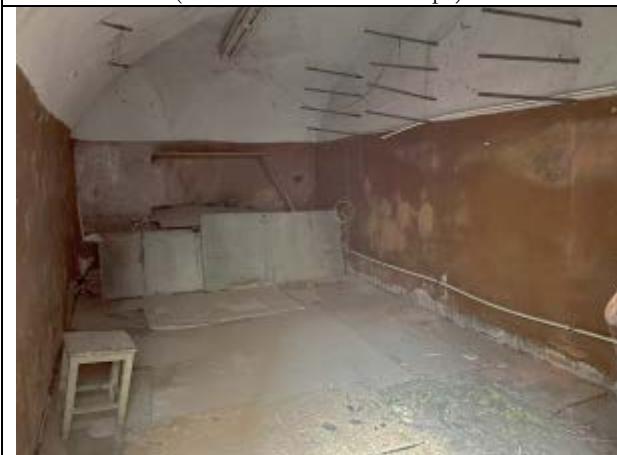
Фото 37. Типичное состояние помещения 12-Н
