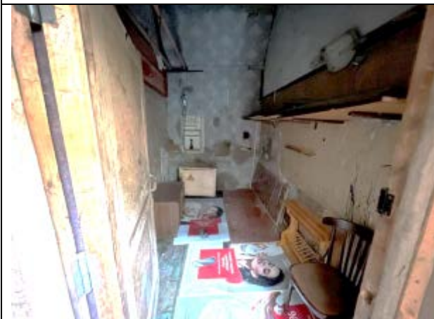
Фото 39. Типичное состояние помещения 13-Н
