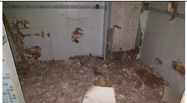
Фото 62. Типичное состояние помещения 19-Н
