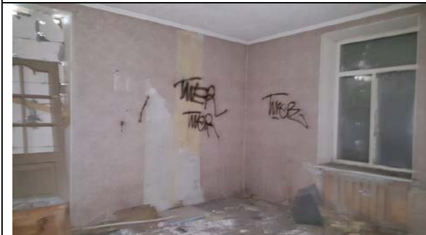
Фото 57. Типичное состояние помещения 17-Н
