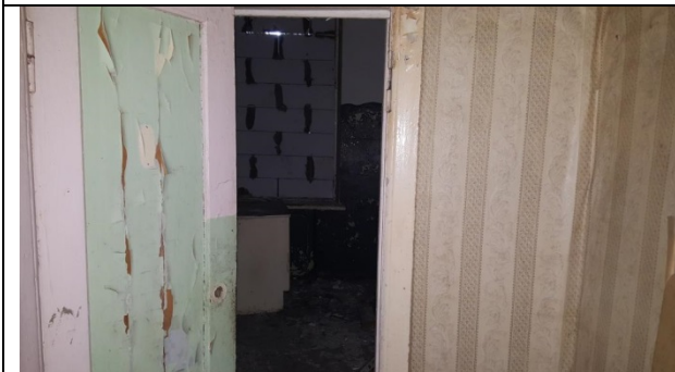
Фото 59. Типичное состояние помещения 18-Н
