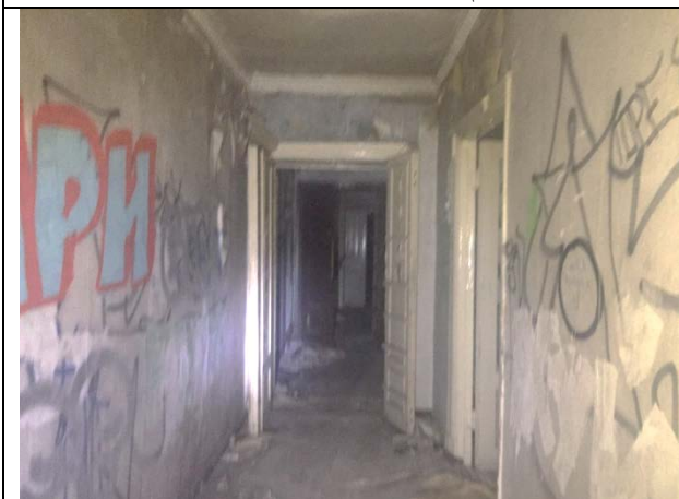
Фото 41. Типичное состояние помещения 13-Н
