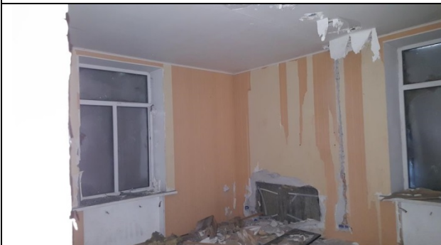
Фото 49. Типичное состояние помещения 15-Н
