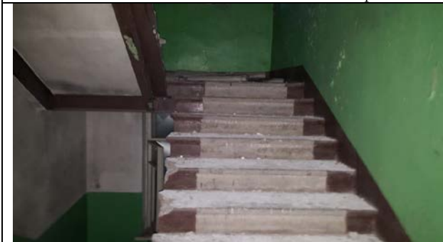
Фото 19. Типичное состояние лестничных проемов
