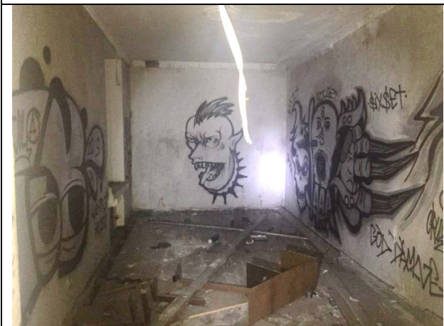
Фото 27. Типичное состояние помещения 8-Н
