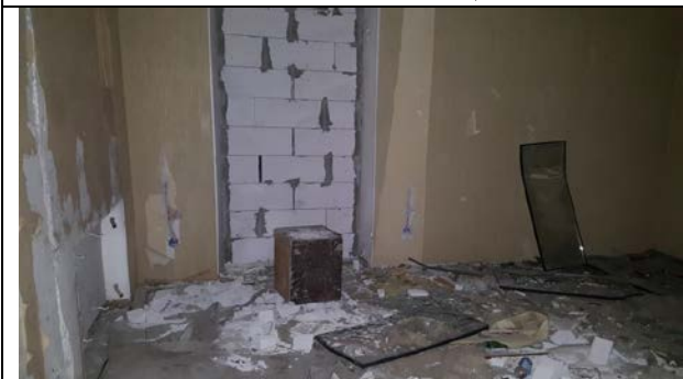
Фото 51. Типичное состояние помещения 15-Н
