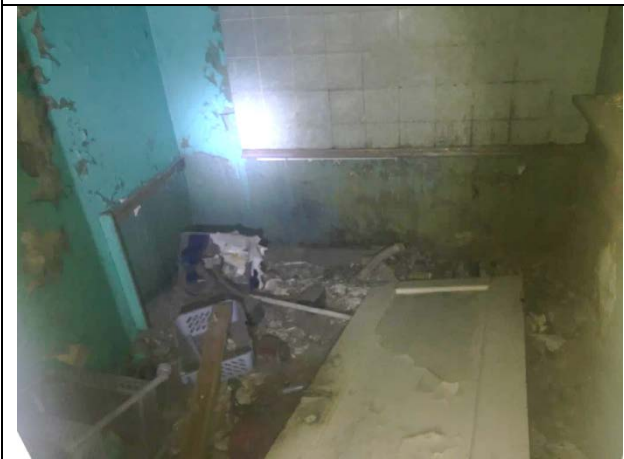
Фото 23. Типичное состояние помещения 6-Н
