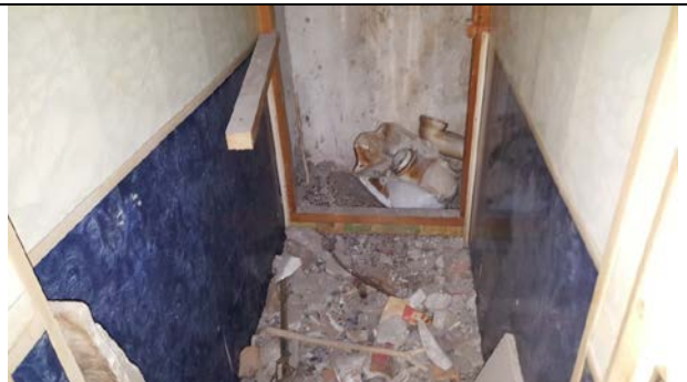
Фото 48. Типичное состояние помещения 14-Н
