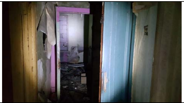
Фото 46. Типичное состояние помещения 14-Н
