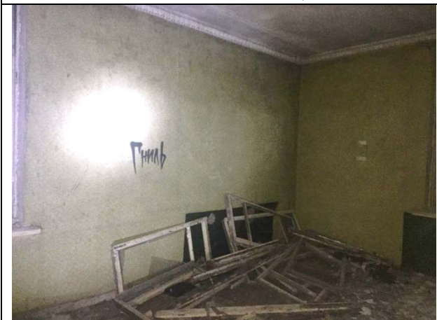
Фото 25. Типичное состояние помещения 7-Н
