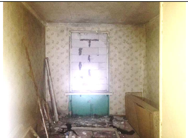
Фото 24. Типичное состояние помещения 6-Н
