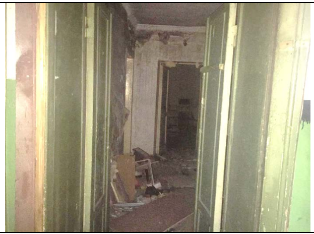
Фото 22. Типичное состояние помещения 5-Н
