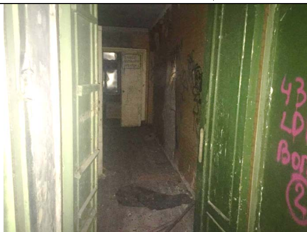
Фото 32. Типичное состояние помещения 9-Н
