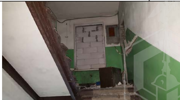
Фото 20. Типичное состояние лестничных кластков
