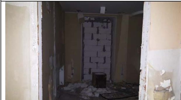
Фото 61. Типичное состояние помещения 19-Н
