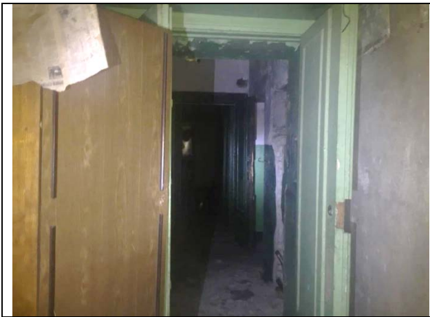
Фото 29. Типичное состояние помещения 8-Н
