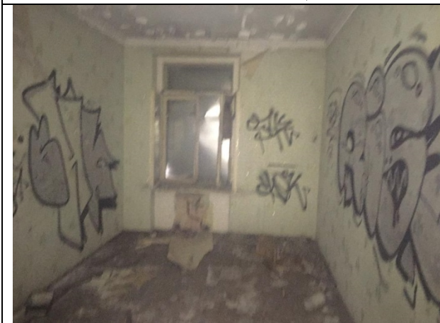
Фото 39. Типичное состояние помещения 12-Н
