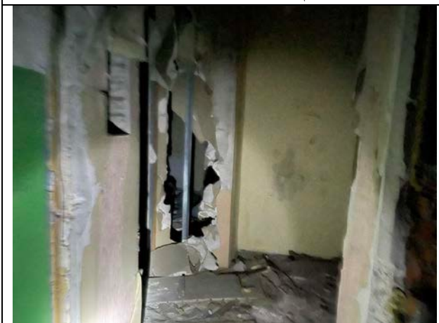
Фото 31. Типичное состояние помещения 9-Н
