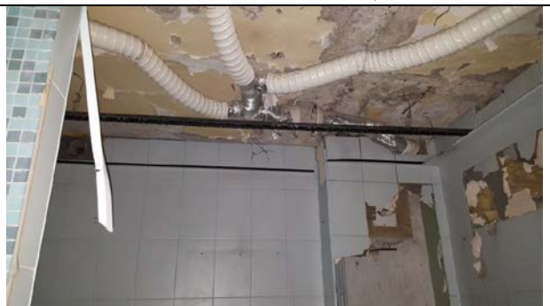
Фото 52. Типичное состояние помещения 15-Н
