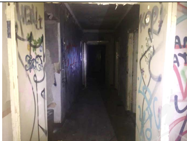
Фото 44. Типичное состояние помещения 13-Н
