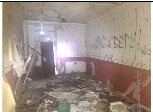
Фото 28. Типичное состояние помещения 8-Н
