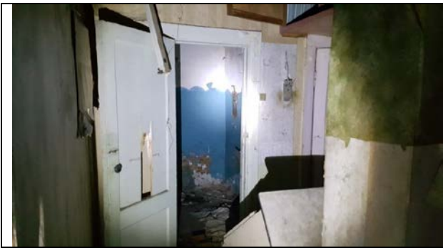
Фото 45. Типичное состояние помещения 14-Н
