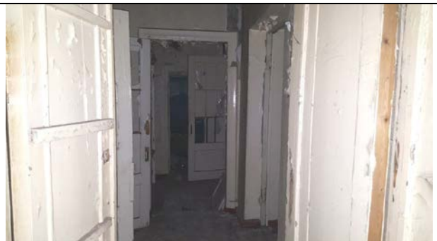
Фото 60. Типичное состояние помещения 18-Н
