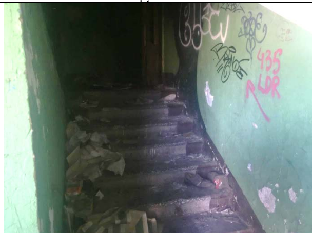
Фото 18. Типичное состояние лестничных проемов
