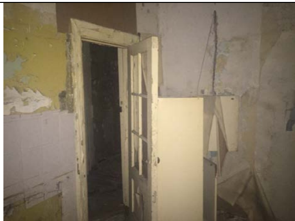
Фото 38. Типичное состояние помещения 11-Н
