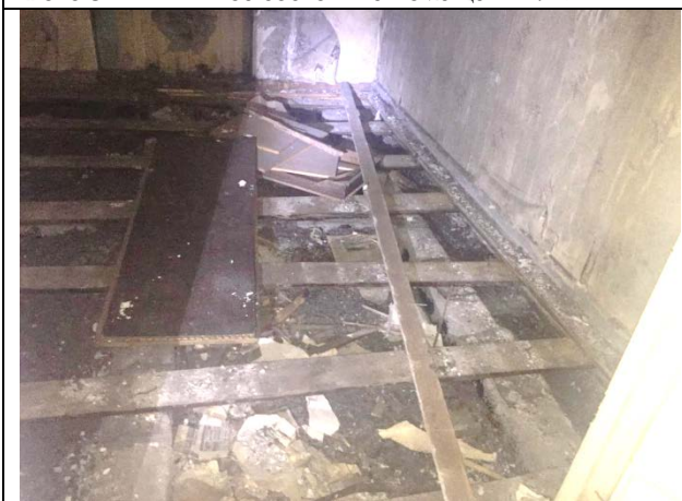
Фото 33. Типичное состояние помещения 10-Н
