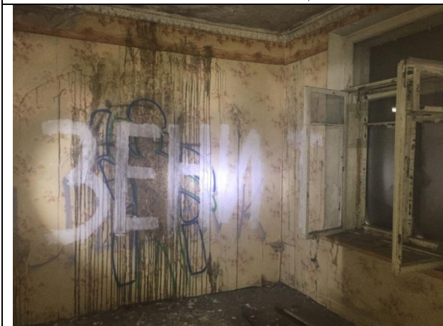
Фото 43. Типичное состояние помещения 13-Н
