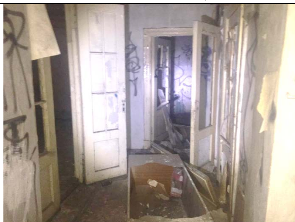
Фото 42. Типичное состояние помещения 13-Н
