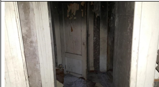
Фото 63. Типичное состояние помещения 19-Н
