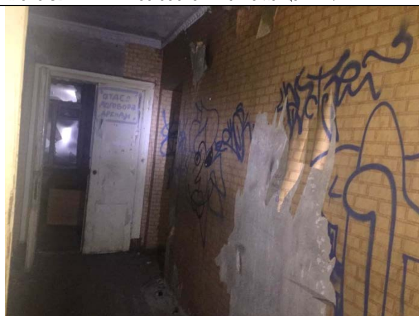
Фото 34. Типичное состояние помещения 10-Н
