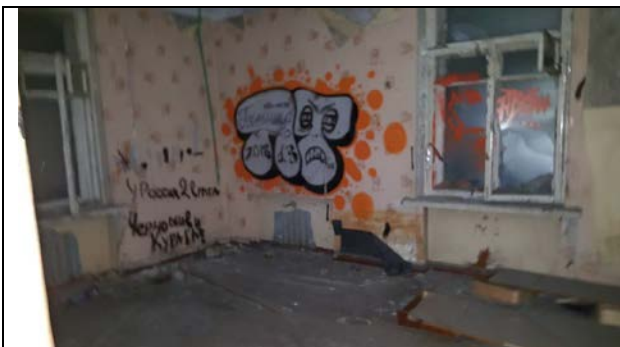
Фото 55. Типичное состояние помещения 16-Н
