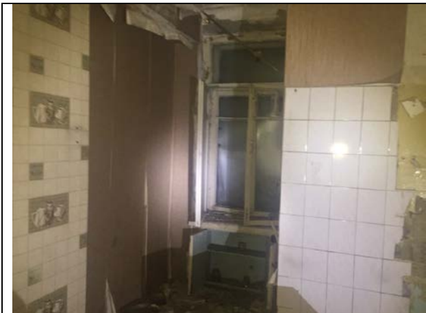
Фото 37. Типичное состояние помещения 11-Н
