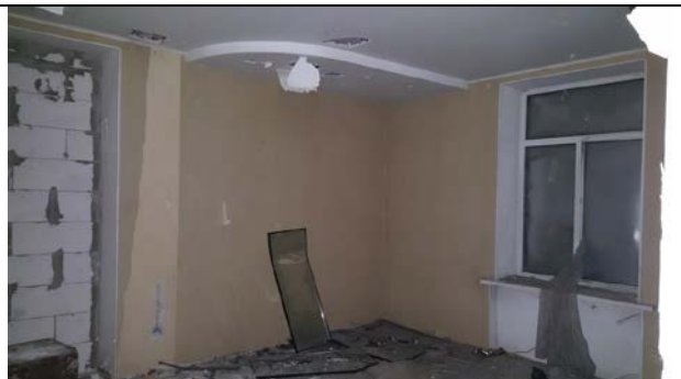
Фото 50. Типичное состояние помещения 15-Н
