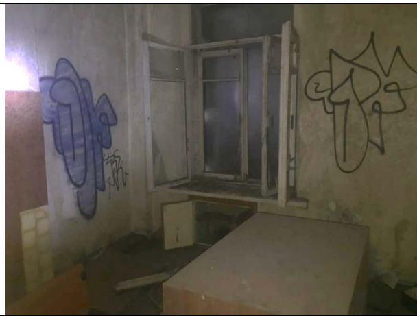
Фото 30. Типичное состояние помещения 8-Н
