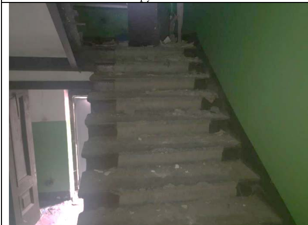
Фото 17. Типичное состояние лестничных проемов
