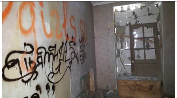
Фото 58. Типичное состояние помещения 17-Н
