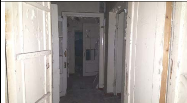
Фото 47. Типичное состояние помещения 14-Н
