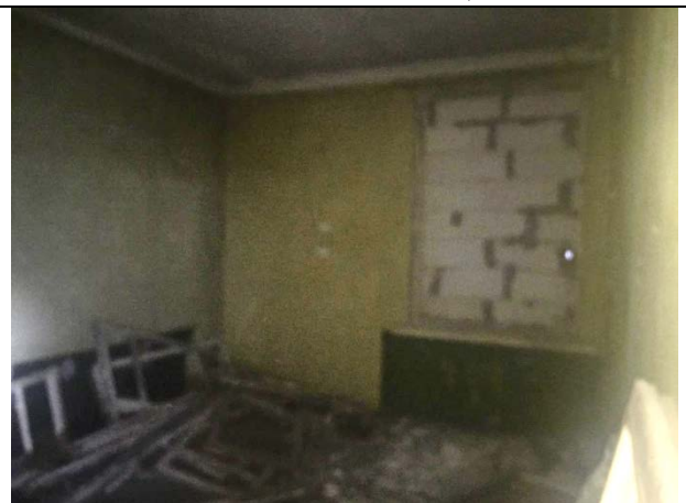
Фото 26. Типичное состояние помещения 7-Н
