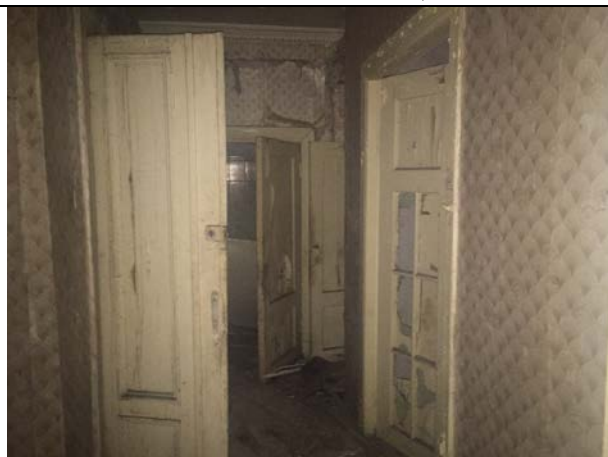
Фото 40. Типичное состояние помещения 12-Н
