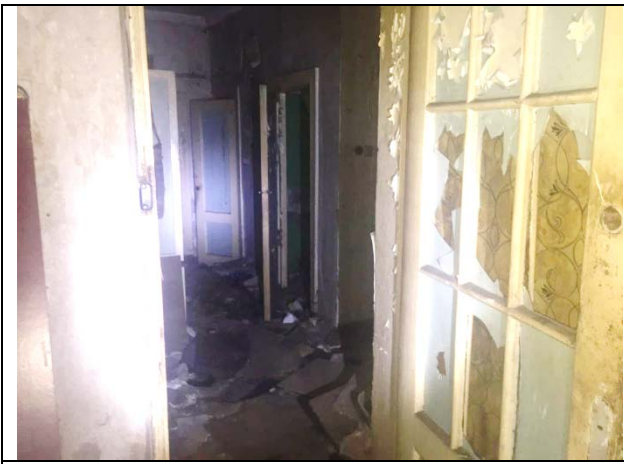
Фото 21. Типичное состояние помещения 5-Н
