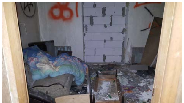
Фото 56. Типичное состояние помещения 16-Н
