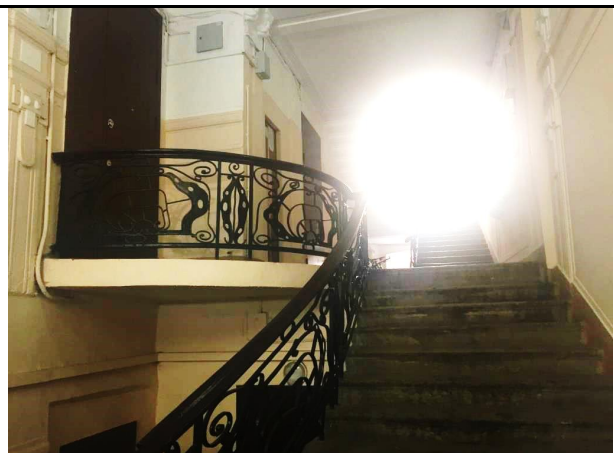
Фото 18. Типичное состояние лестничной площадки Объекта оценки
