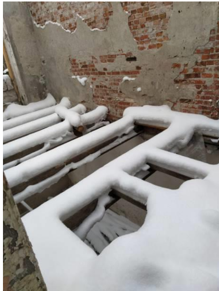
Фото 9. Состояние кладки (разрушение местами), отсутствие штукатурного слоя
