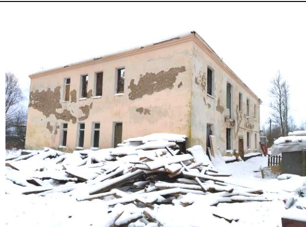
Фото 2. Территория Объекта оценки. Вид на фасад Объекта оценки. Отсутствие заполнений (остекления) оконных проемов
