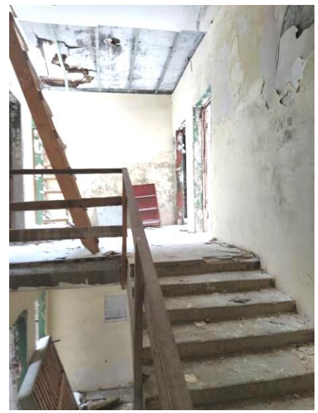
Фото 10. Состояние лестницы и отделки
