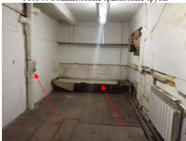
Фото 11. Общедомовые транзитные трубы
