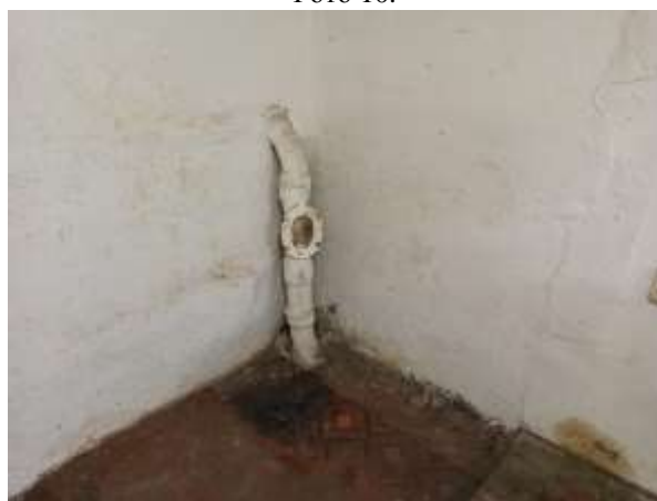
Фото 12. Общедомовые транзитные трубы
