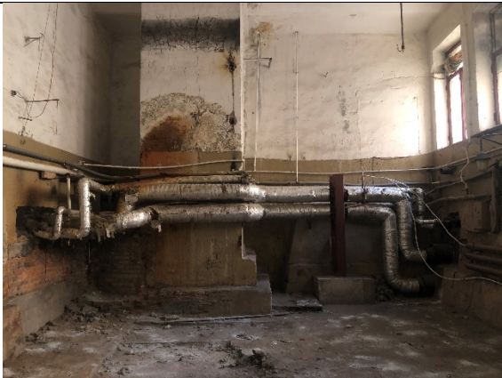
Фото № 15 - Транзитные трубопроводы отопления ООО «Петербургтеплоэнерго»
