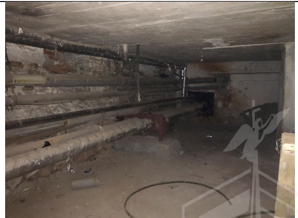
Фото № 16 - Транзитные трубопроводы отопления ООО «Петербургтеплоэнерго»
