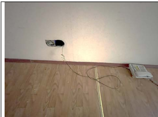
Фото 37. Типичное состояние Объекта оценки (элементы электроснабжения)
