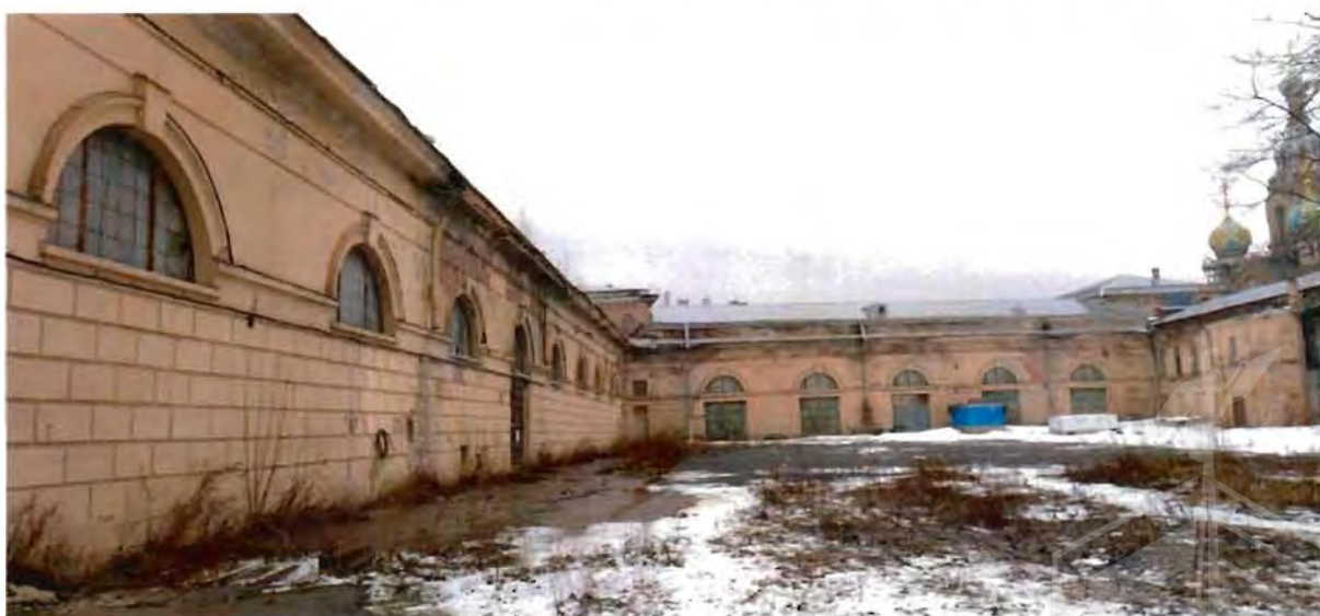
8. Вид на западный дворовый фасад и фрагмент южного дворового фасада объекта культурного наследия.
