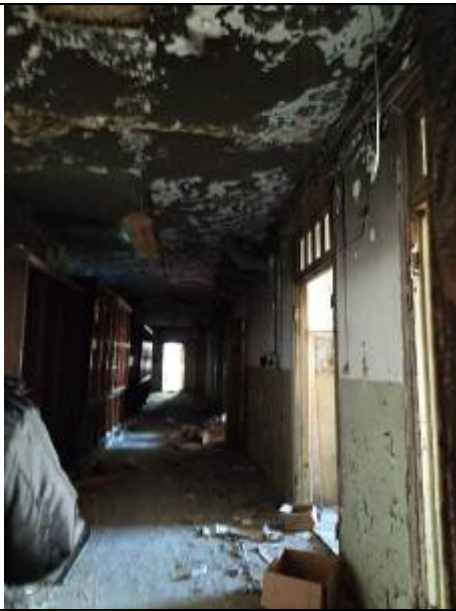
Фото 23. Следы пожара в помещении
