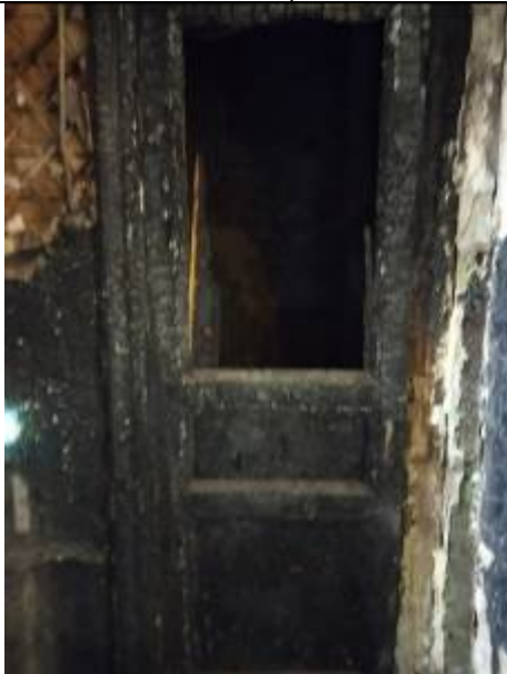
Фото 25. Следы пожара в помещении
