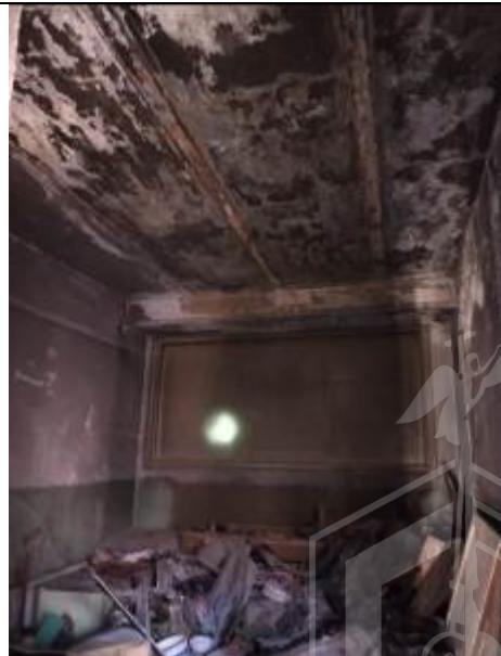
Фото 22. Следы пожара в помещении
