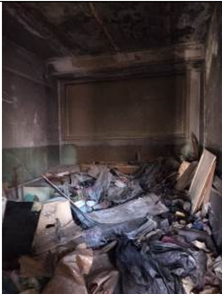
Фото 21. Следы пожара в помещении
