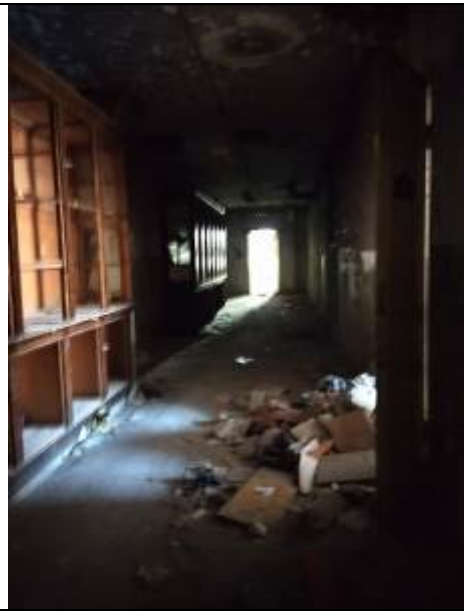
Фото 24. Следы пожара в помещении
