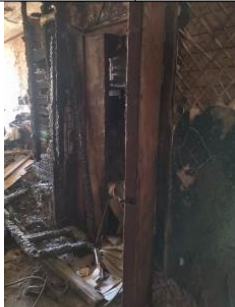
Фото 26. Следы пожара в помещении
