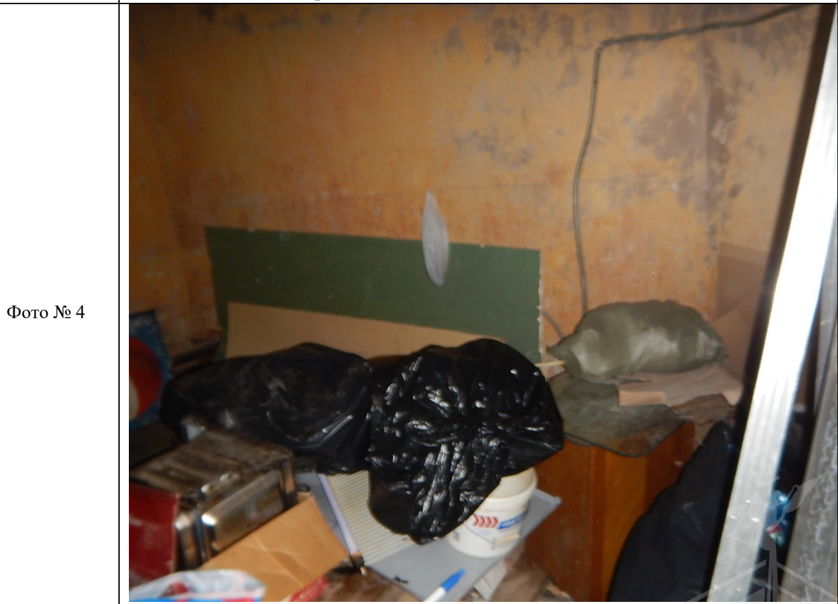
Описание: общий вид ч.п. 1. Строительный и бытовой мусор.
