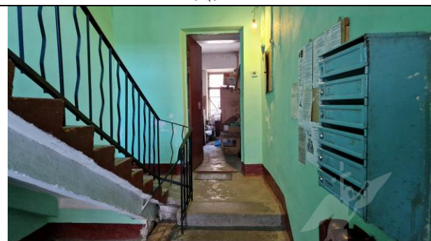
Фото 18. Состояние общей Входной группы Объекта оценки
