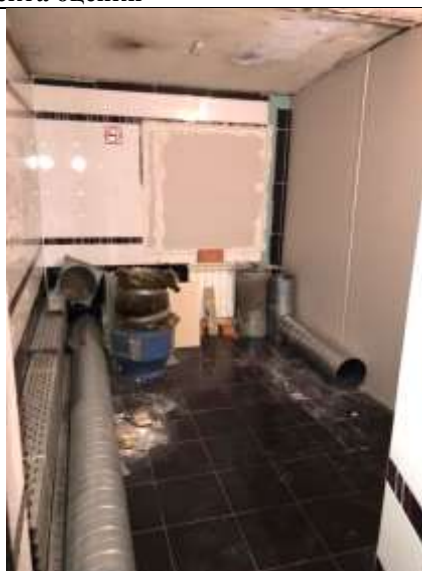
Фото 10. Внутреннее состояние Объекта оценки (окно зашито изнутри)
