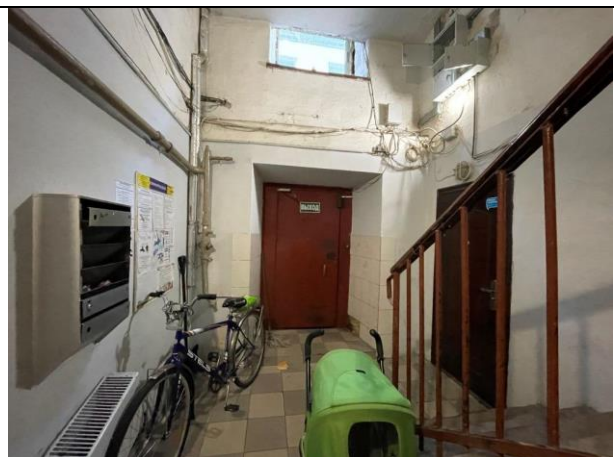
Фото 18. Состояние лестничной клетки
