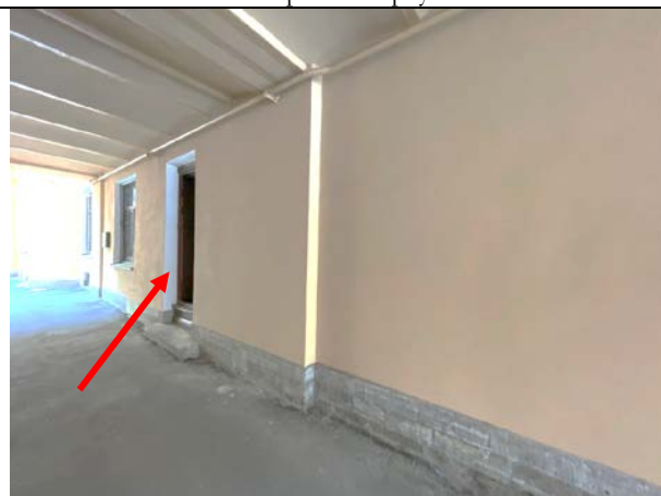
Фото 16. Проход через арку к Объекту оценки (вход Объекта оценки из под арки (со двора))
