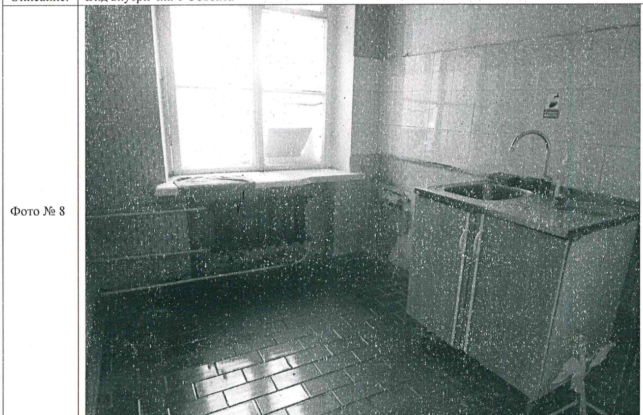
Описание: В ч.п. 3 Объекта установлено сантехническое оборудование (раковина)
