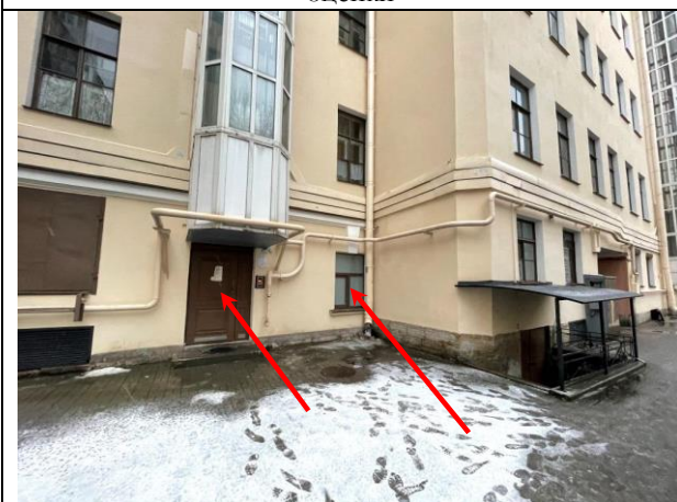
Фото 35. Вид здания расположения Объекта оценки, входная и оконная группа Объекта оценки (вход со двора)
