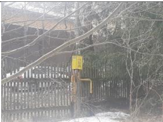
Фото 9. Вид на Объект оценки (Газовый распределительный щит)
